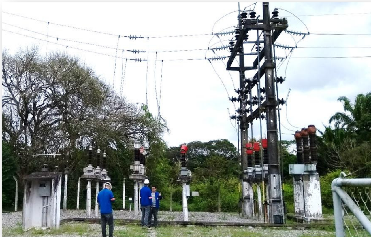
Figura 1. Vista Geral do ramal de alimentação da subestação Gramame.
