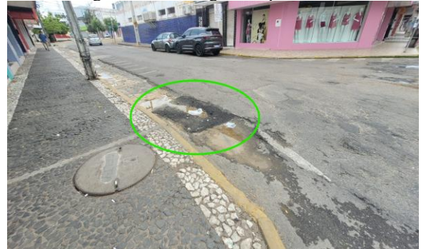
Figura 10: Patologias no pavimento
