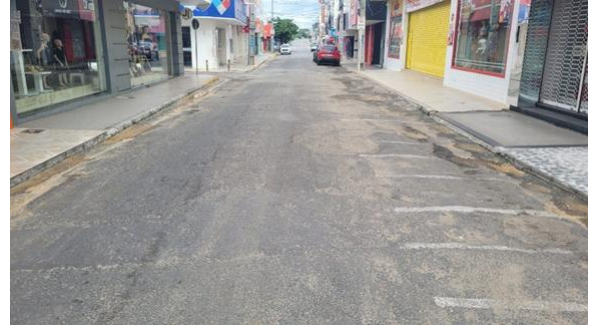
Figura 08: Rua Coronel Juvêncio Carneiro, inexistência de sarjetas e bocas de lobo
