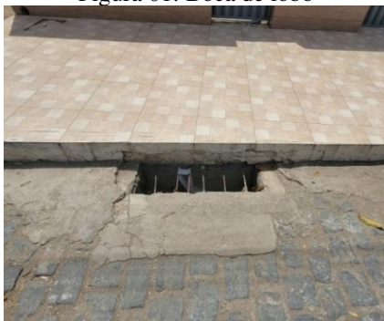
Figura 01: Boca de lobo
