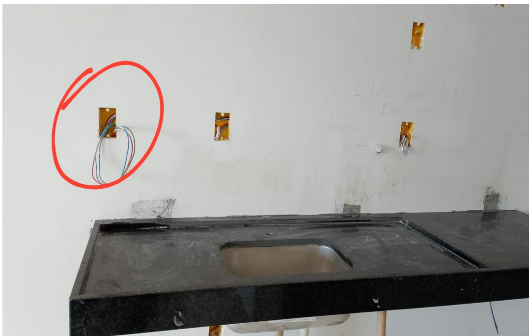
Figura 7 – Fechamento prematuro de pontos elétricos e hidrossanitários
