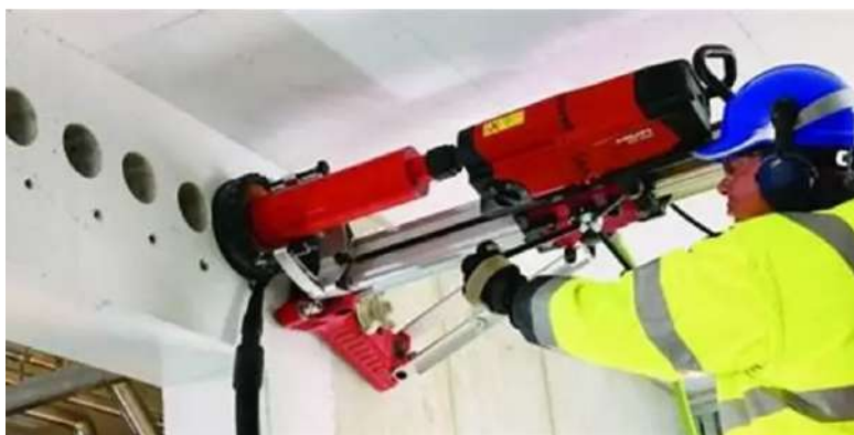
Figura 4 - Execução inadequada de furos em viga de concreto para passagem de tubulações de acordo com a NBR 6118:2023.
