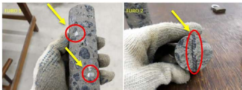
Figura 20 - Seccionamento de armaduras transversais
