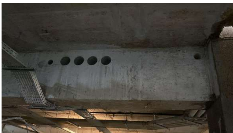
Figura 9 - Execução irregular de furos em viga estrutural
