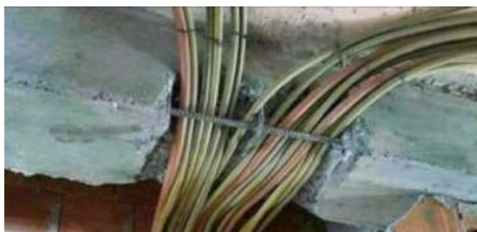
Figura 8 - Seccionamento irregular da viga para passagens de tubulações
