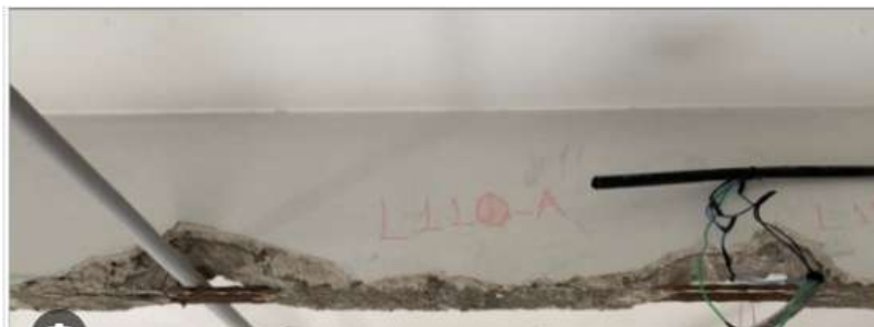
Figura 15 - Exposição de armaduras causada pela execução de abertura
