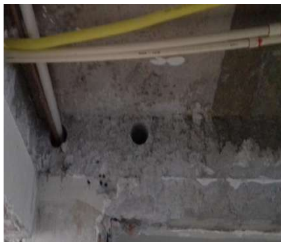
Figura 21 - Deslocamento do cobrimento de concreto em viga decorrente da execução de furo em viga
