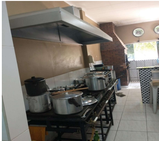
Figura 5: Cozinha após a implantação das medidas de engenharia Fonte: Dados da pesquisa (2023).
