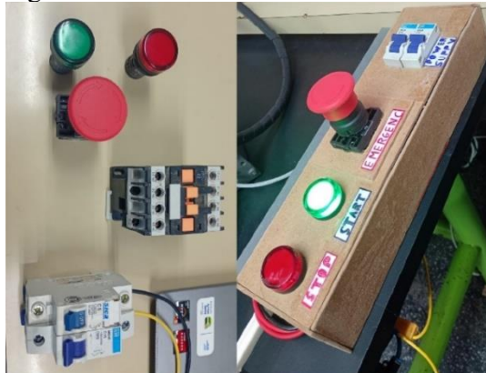
Figura 4 - Painel Elétrico de Acionamento
