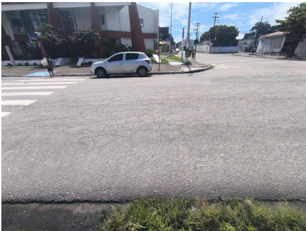
Figura 29 - Trinca em Blocos
