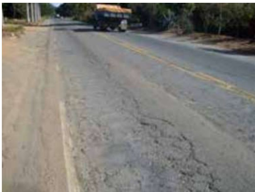
Figura 18 - Afundamento de consolidação
