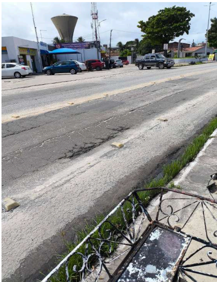
Figura 31 - Afundamentos de Consolidação
