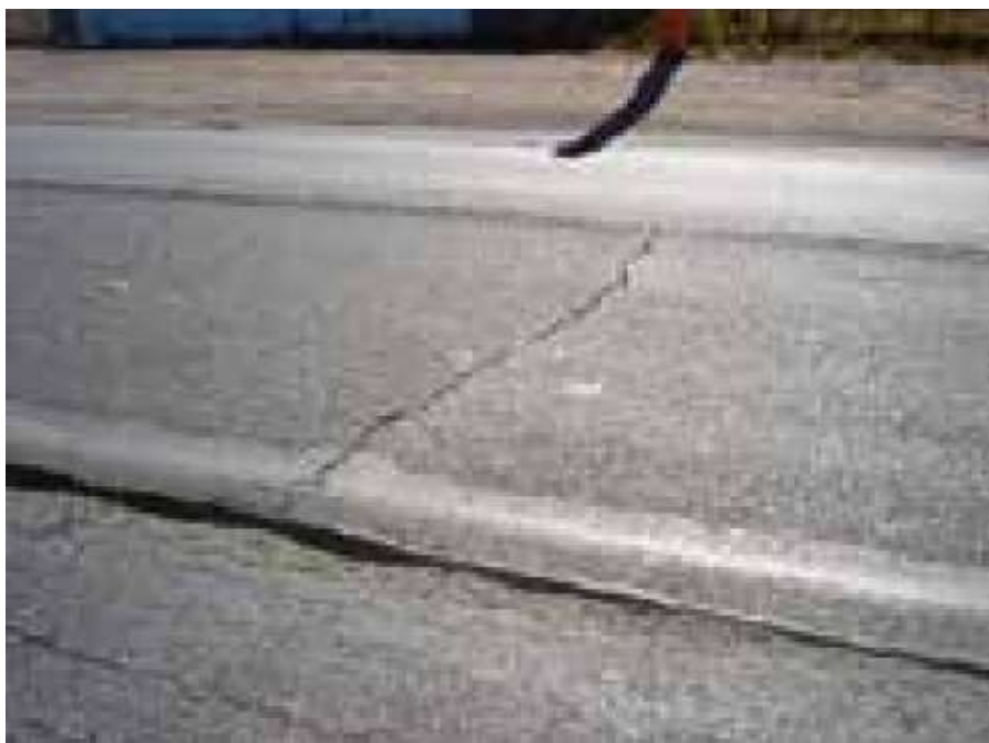
Figura 14 - Trinca de retração
