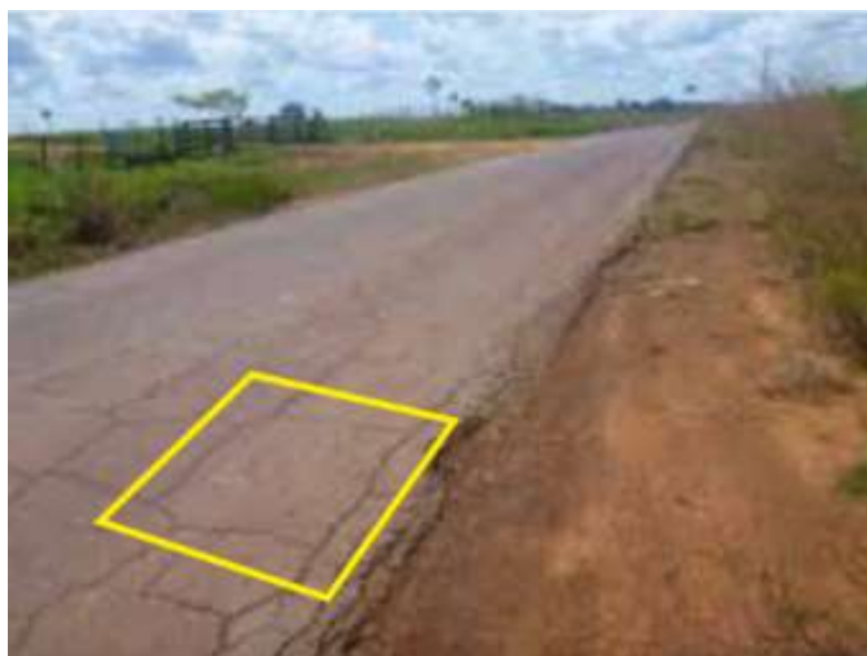
Figura 16 - Trinca tipo “Bloco”
