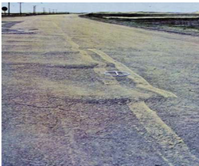
Figura 19 - Ondulação ou Corrugação
