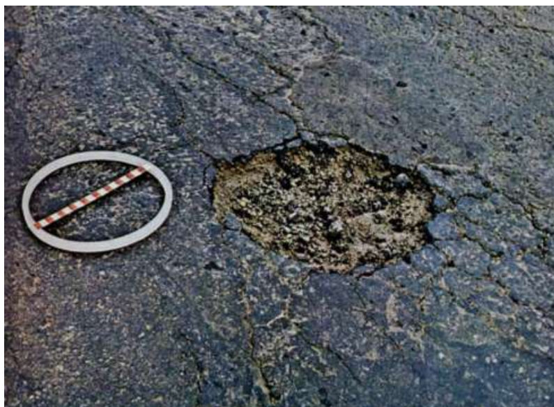
Figura 23 - Panela ou buraco
