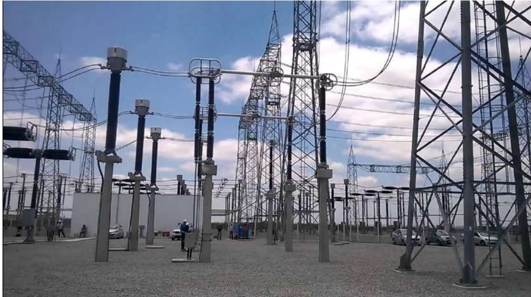
Figura 10 – Chave Seccionadora em Subestação
