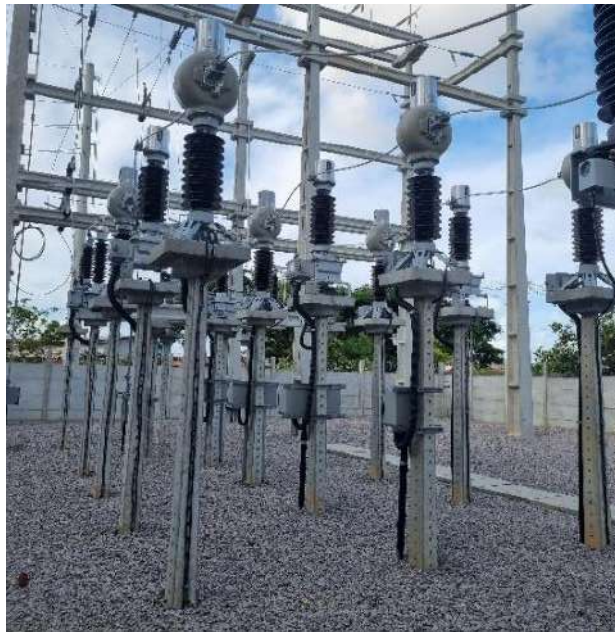
Figura 8 – Transformador de Corrente de Barra, ligado no barramento de 69 kV
