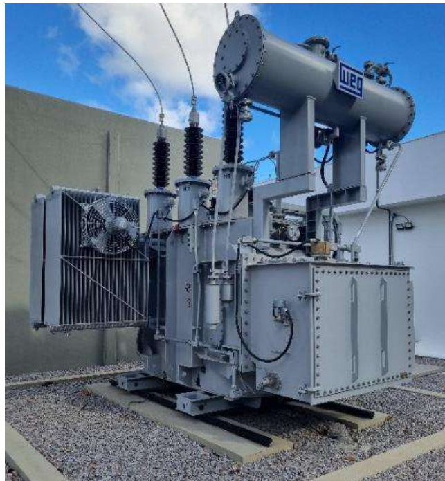
Figura 7 – Transformador de Potência 6,5/5 MVA
