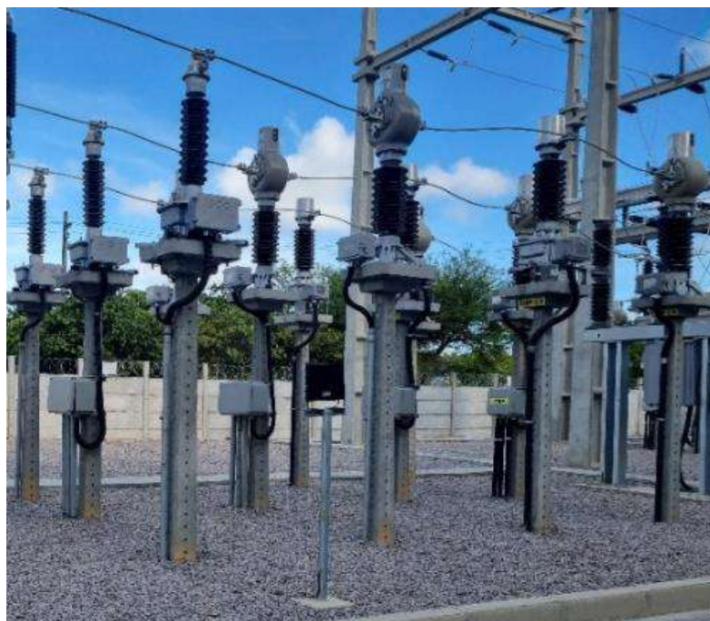
Figura 9 – Transformadores de Potencial Instalados num Barramento de 69 kV
