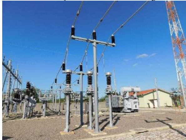
Figura 1 – Pátio de Subestação com Sistema de Drenagem e Área Britada
