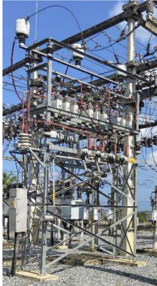
Figura 13 – Banco de Capacitores
