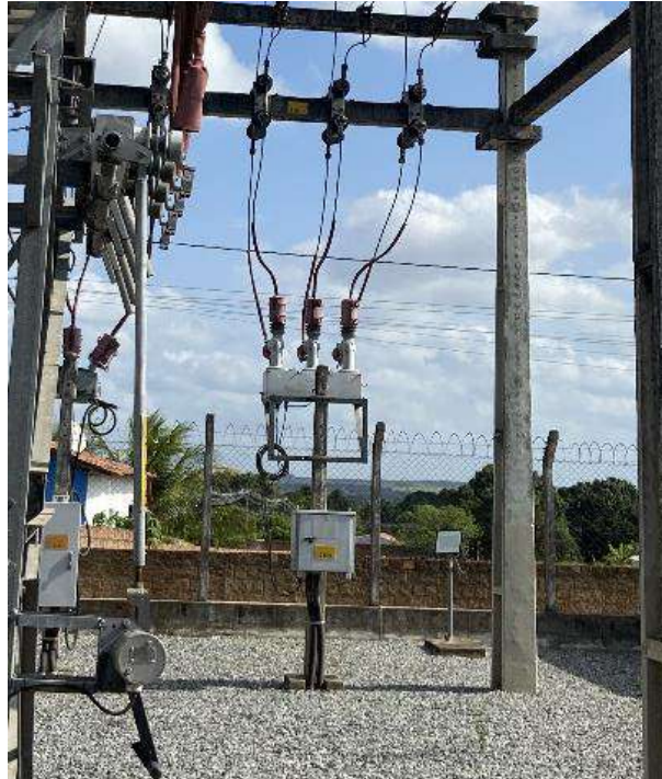
Figura 12 – Religador Automático Instalado na Saída 13,8 kV
