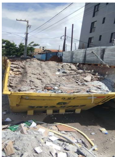
Figura 4 – Baías de armazenamento e segregação dos resíduos
