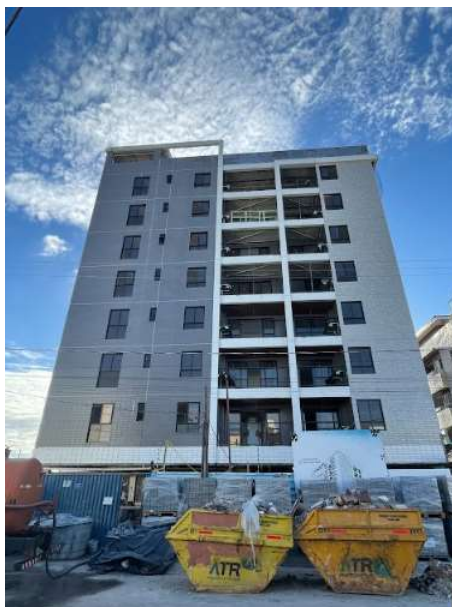
Figura 10 – Disposição das caçambas estacionárias
