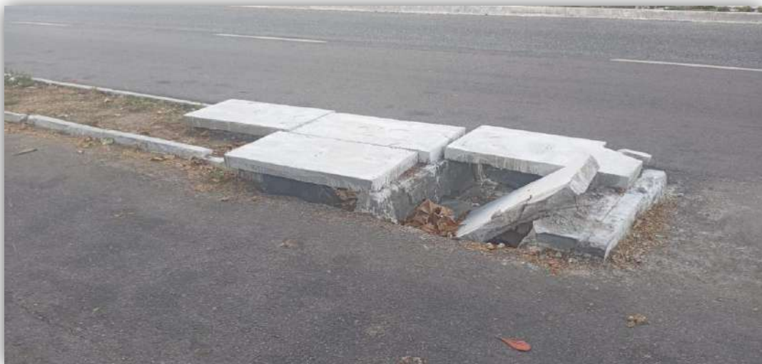
Figura 26 - Boca de lobo com deslocamento e desnível da laje de cobertura
