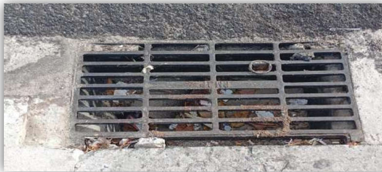
Figura 19 - Boca de lobo com grelha superior parcialmente obstruída por resíduos sólidos
