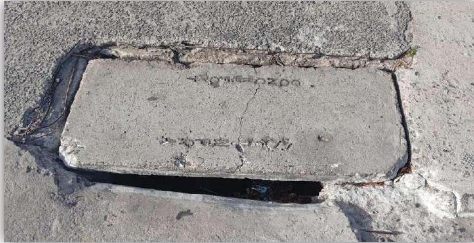
Figura 17 - Boca de lobo com tampa de concreto fissurada e deslocamento parcial
