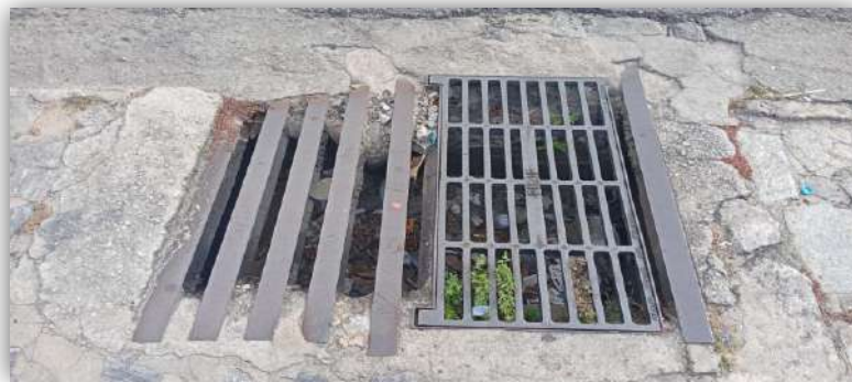
Figura 20 - Boca de lobo com grelhas metálicas deslocadas e seção de entrada comprometida
