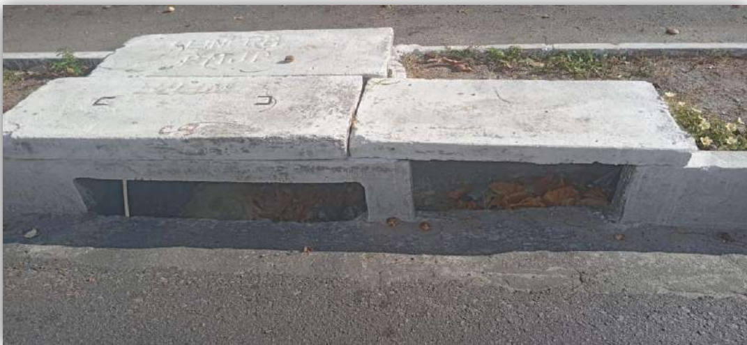
Figura 27 - Boca de lobo dupla em concreto com acúmulo de resíduos sólidos
