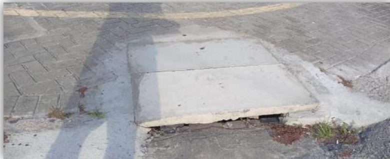
Figura 14 - Boca de lobo com degradação estrutural e inadequada recomposição do pavimento
