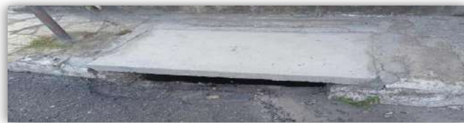
Figura 12 - Boca de lobo com abertura parcialmente comprometida e desgaste estrutural
