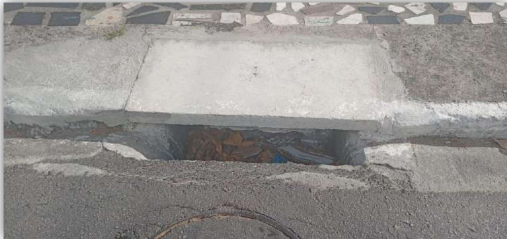
Figura 25 - Boca de lobo com abertura inferior exposta e acúmulo de resíduos sólidos
