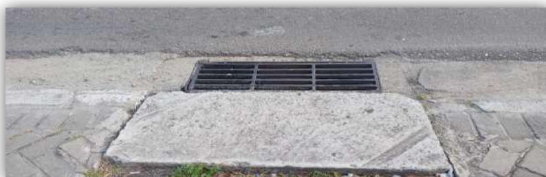
Figura 15 - Boca de lobo com grelha metálica para captação de águas pluviais
