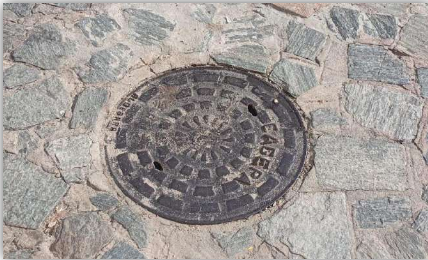
Figura 21 - Tampa de poço de visita (PV) integrante da rede de drenagem pluvial
