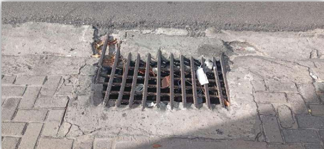
Figura 22 - Boca de lobo com grelha danificada e presença de resíduos sólidos
