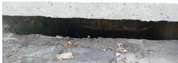
Figura 13 - Redução da seção hidráulica em galeria pluvial devido a desgaste e acúmulo de resíduos
