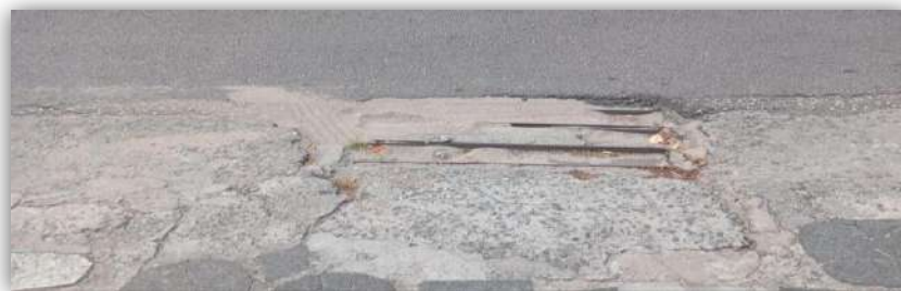
Figura 23 - Boca de lobo com grelha parcialmente exposta e deficiência de direcionamento do escoamento superficial
