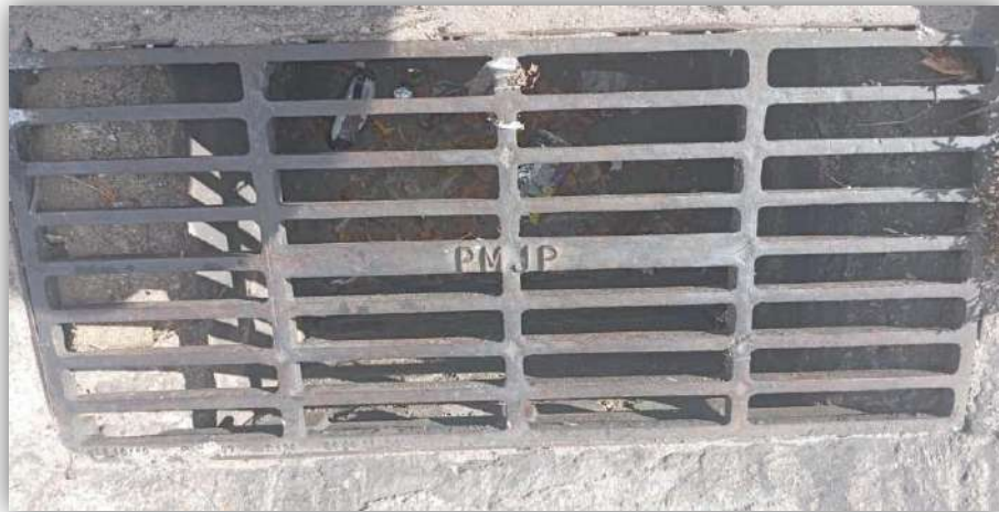
Figura 28 - Boca de lobo com grelha metálica parcialmente obstruída por resíduos sólidos
