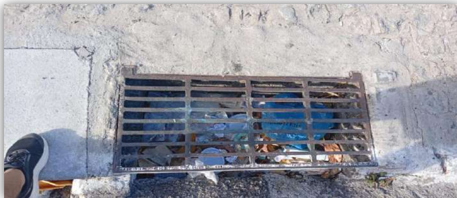
Figura 18 - Boca de lobo com grelha metálica apresentando acúmulo de resíduos sólidos
