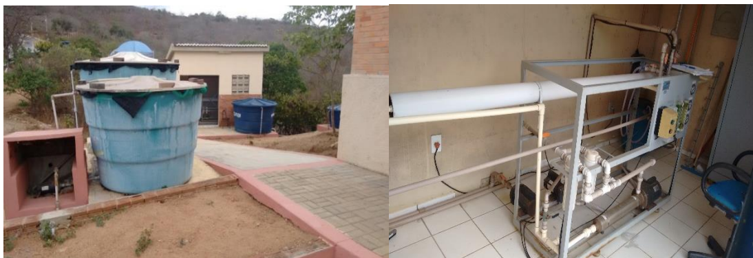
Figura 9: Complexo de Dessalinização
