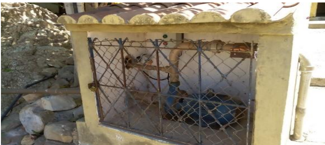
Figura 22: Sistema de bombeamento mecânico
