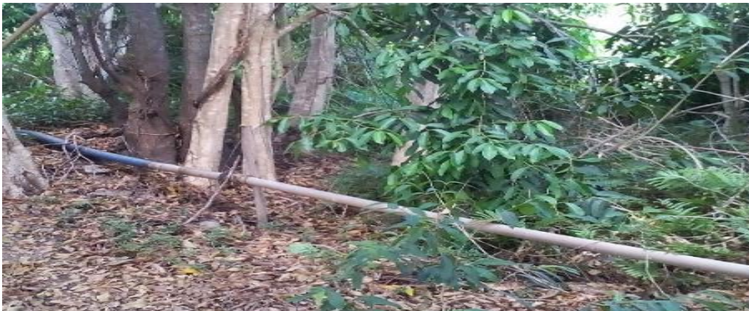
Figura 21: Distribuição de água da (F2) por gravidade
