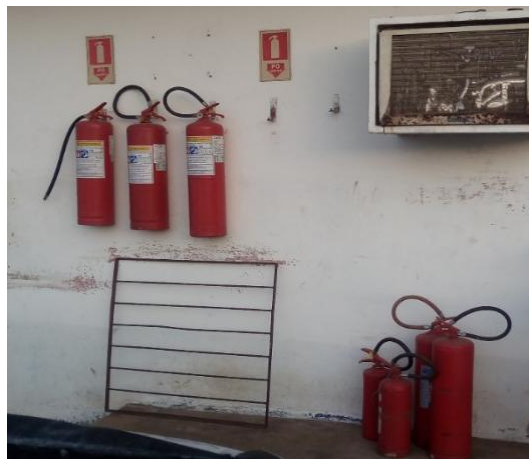
Figura 09- Extintores e suas localizações.
