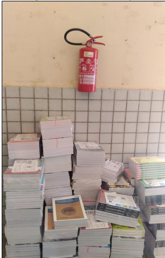
Figura 9 – Extintor sem sinalização.
