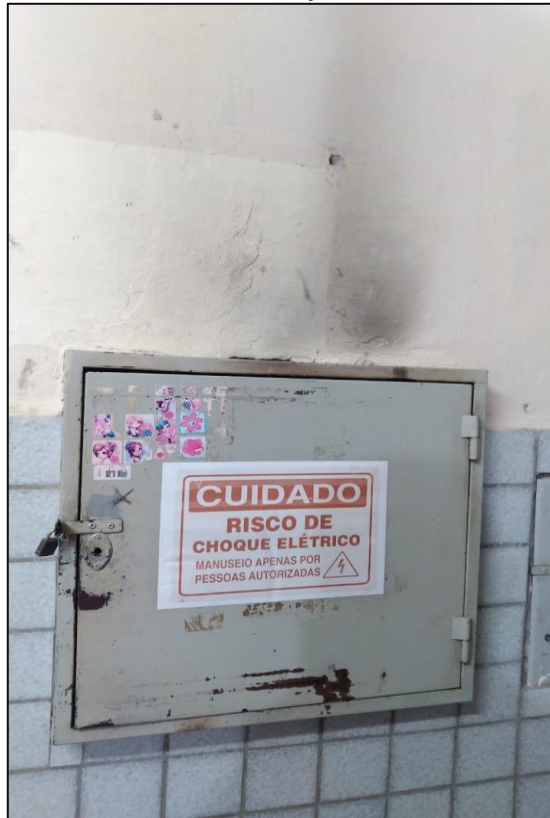
Figura 10 – Quadro de distribuição dos circuitos terminais.
