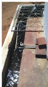
Figura 2.2: Canal de Parshall
