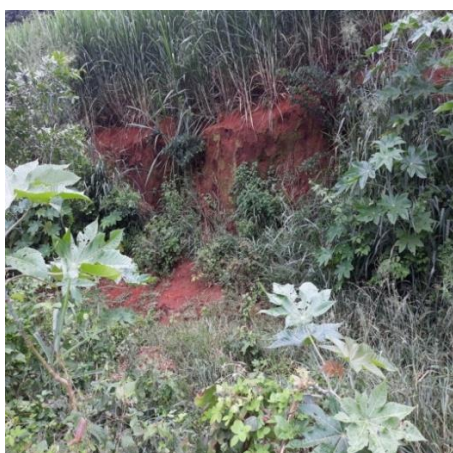
Figura 16: Processo erosivo às margens do riacho, Sítio Icó.
