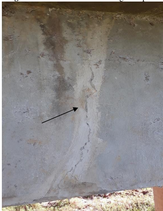
Figura 13: Fissura em uma das vigas da ponte
