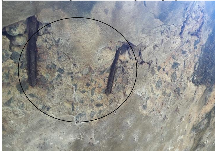
Figura 15: Concreto deslocado com a consequente exposição da armadura
