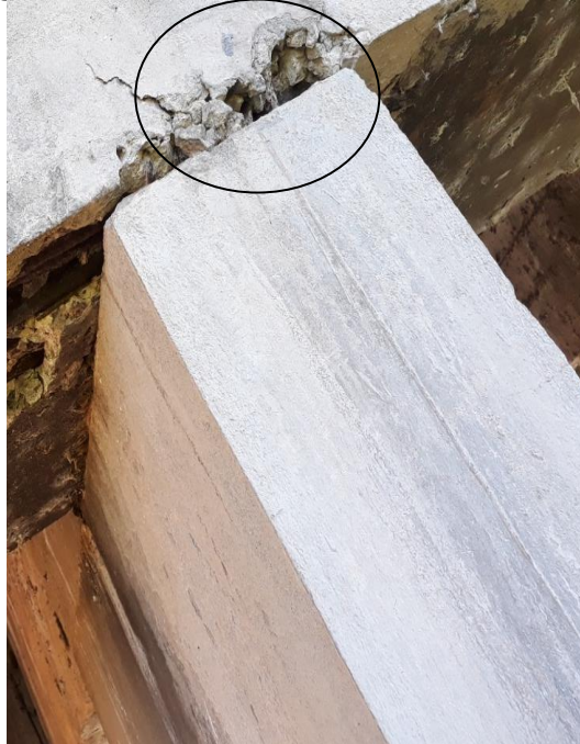
Figura 17: Ninho de concretagem entre a viga e o pilar
