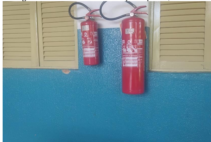
Figura 16: Extintores sem sinalização de parede, escola “I”.
