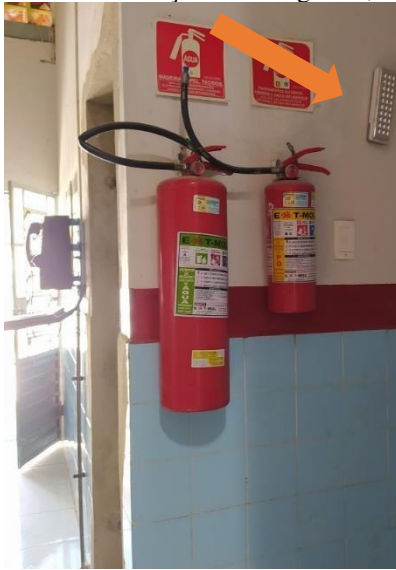
Figura 9: Única iluminação de emergência, escola “H”.
