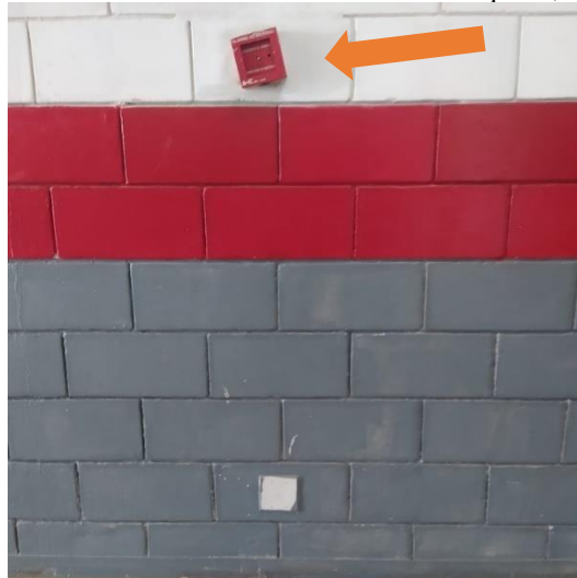
Figura 12: Acionadores manuais com altura inadequada, escola “E”.
