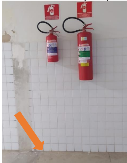
Figura 15: Extintores sem sinalização de piso, escola “D”.
