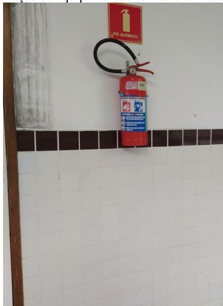
Figura 14: Sinalização de equipamentos com altura inadequada, escola “J”.
