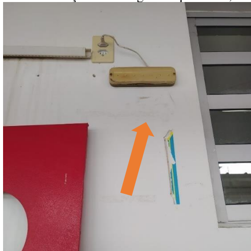
Figura 11: Iluminação de emergência queimada, escola “J”.
