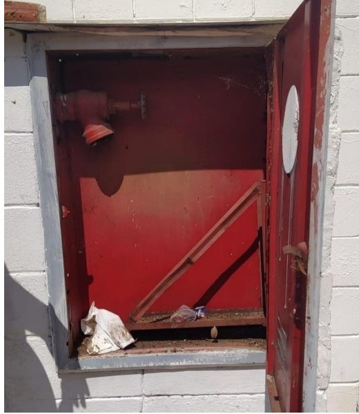
Figura 20: Hidrante sem mangueira no abrigo, escola “E”.
