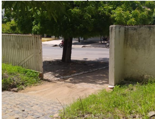
Figura 5: Portão inadequado, escola “D”.
