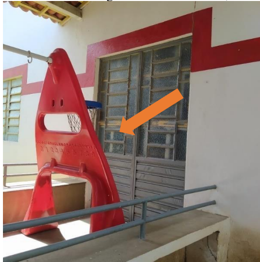
Figura 8: Saída de Emergência com obstáculos, escola “H”.
