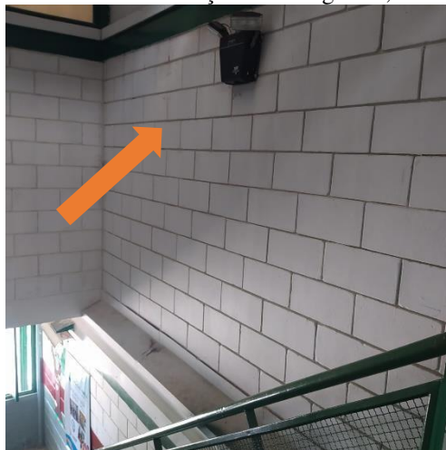
Figura 10: Única iluminação de emergência, escola “E”.
