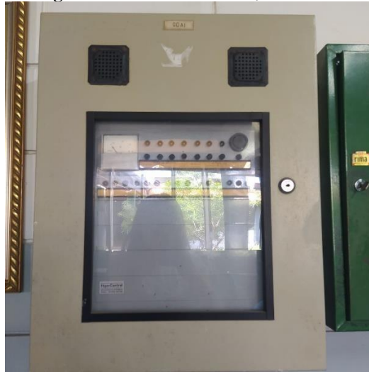
Figura 13: Central de alarme, escola “E”.
