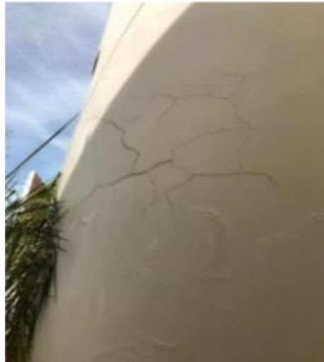
Figura 5 - Fissuras com características inclinadas e mapeadas.
