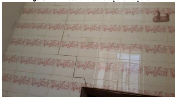
Figura 7 - Rachadura no canto superior de porta.
