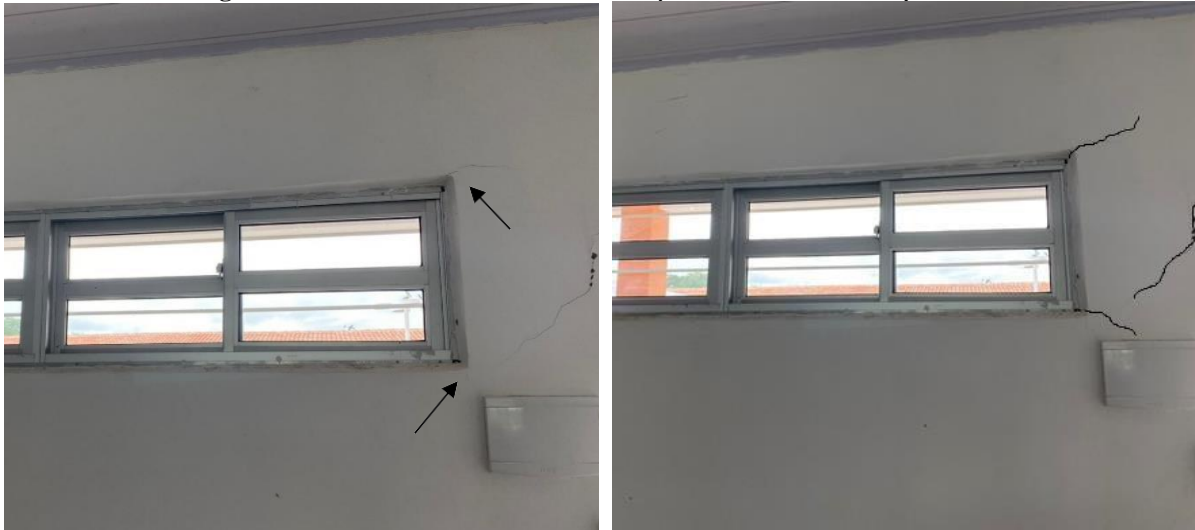
Figura 40 - Trincas inclinadas no canto superior e inferior das esquadrias.
