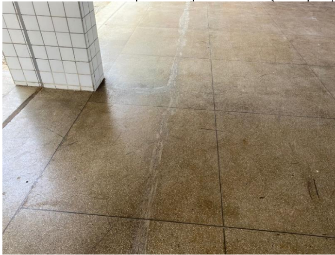
Figura 50 - Trincas observadas próximo a juntas de dilatação do piso granilite.
