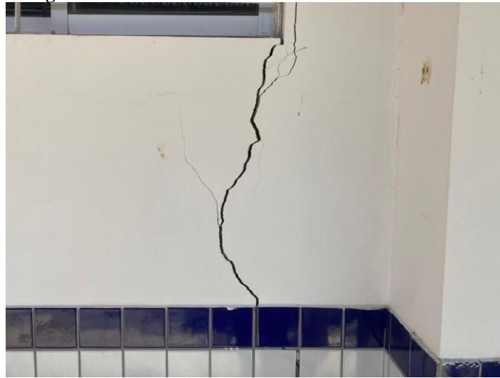
Figura 38 - Rachadura vertical sob os vãos de abertura.
