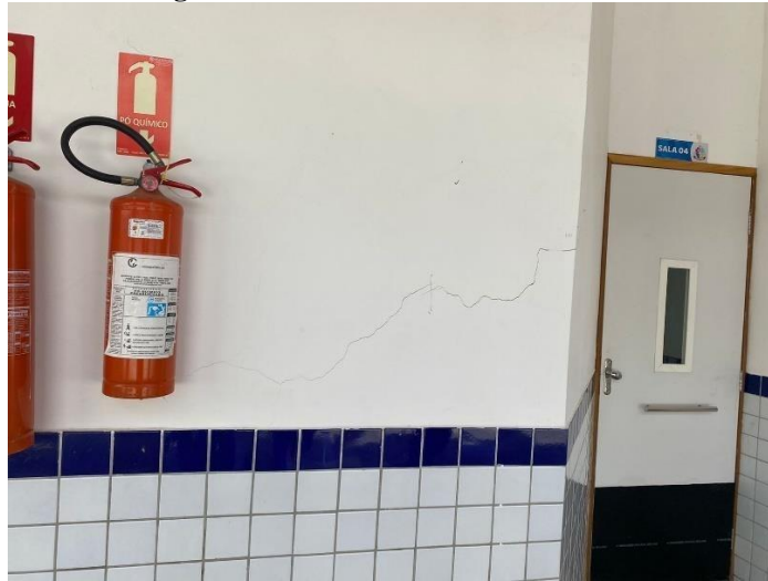
Figura 54 - Trinca transversal na alvenaria.
