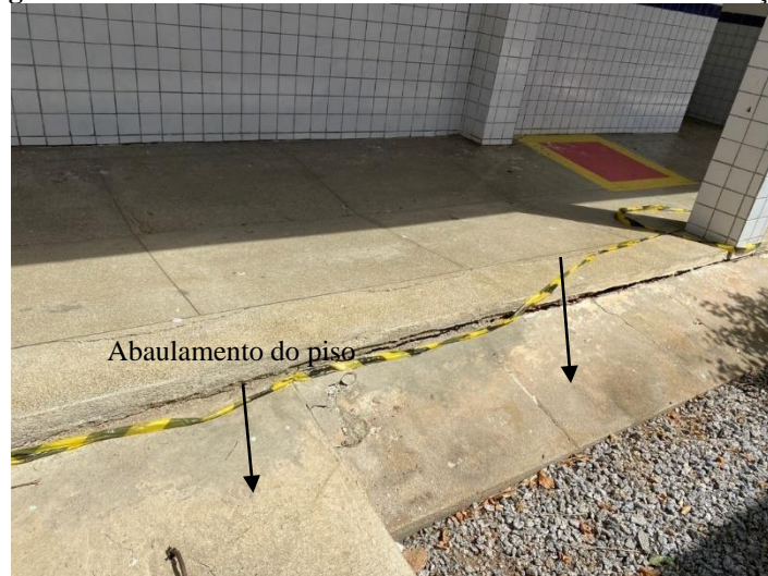
Figura 43 - Fenômeno de abaulamento evidente na área de circulação.
