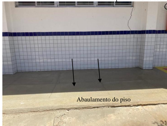
Figura 41 - Fenômeno de abaulamento encontrado no piso em frente aos laboratórios.
