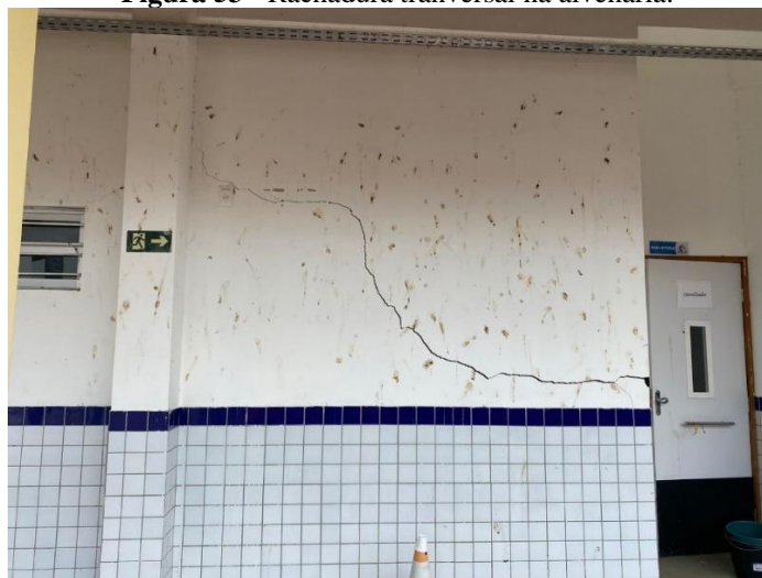
Figura 53 - Rachadura transversal na alvenaria.
