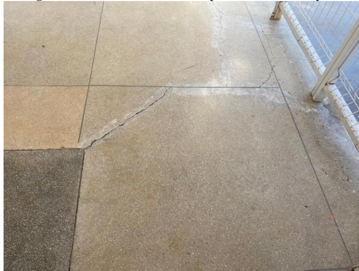
Figura 52 - Rachaduras com rompimento da resina epóxi.
