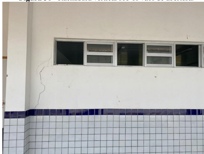
Figura 36 - Rachadura vertical sob os vãos de abertura.
