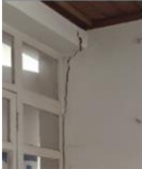
Figura 8 - Fenda causada por sobrecarga do telhado.
