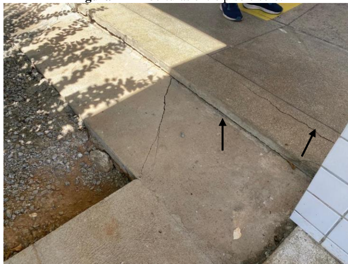
Figura 44 - Aberturas entre piso e solo.
