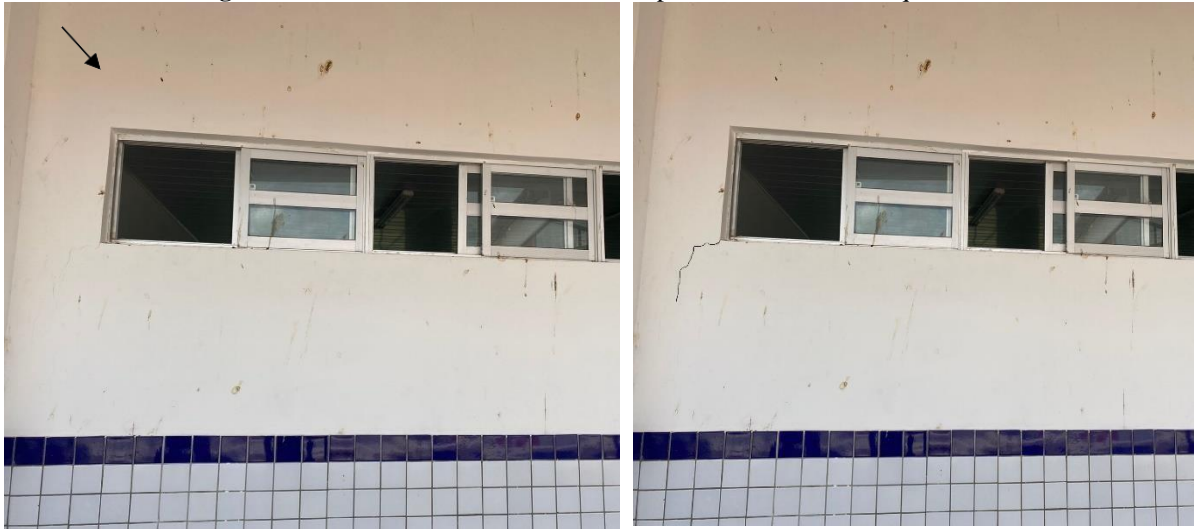
Figura 39 - Fissuras inclinadas no canto superior e inferior das esquadrias.
