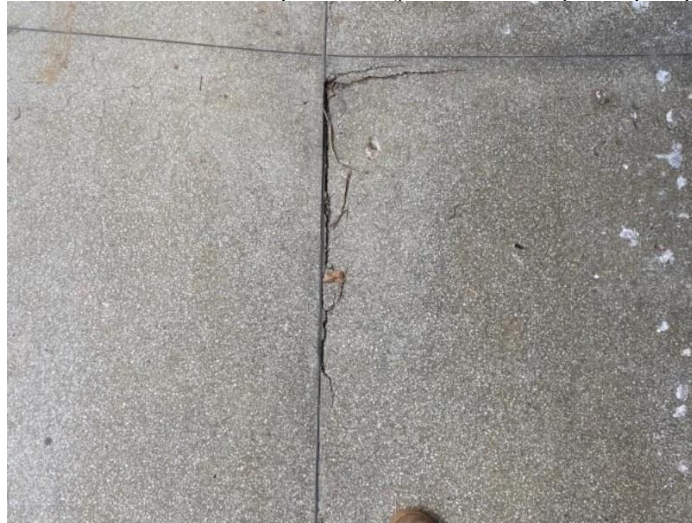
Figura 49 - Trincas observadas próximo a juntas de dilatação do piso granilite.
