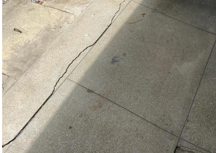
Figura 47 - Trincas observadas próximo a juntas de dilatação do piso granilite.
