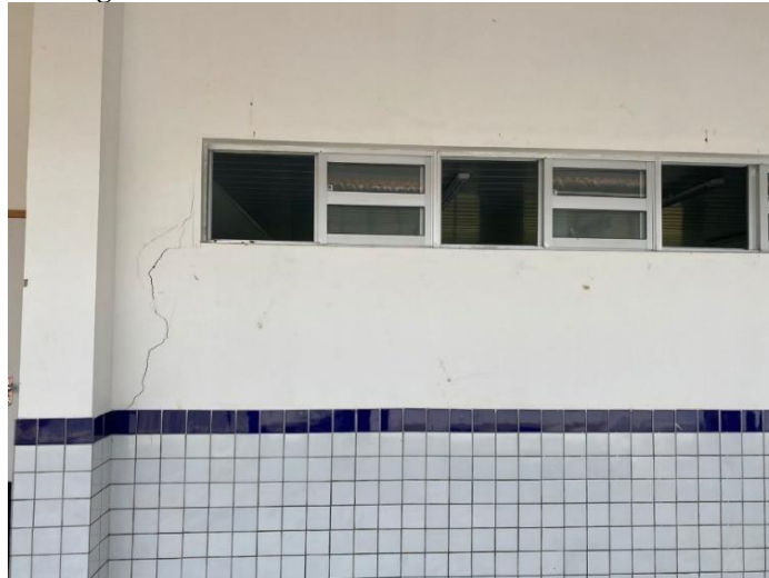
Figura 33 - Rachadura vertical sob os vãos de abertura.
