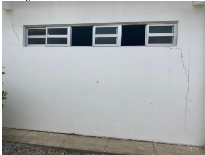
Figura 34 - Rachadura vertical sob os vãos de abertura.
