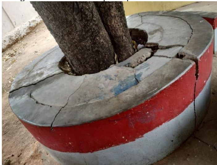
Figura 9 - Brecha causada pela expansão da raiz da árvore.
