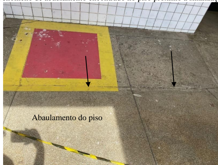
Figura 42 - Fenômeno de abaulamento encontrado no piso próximo a sinalização de incêndio.
