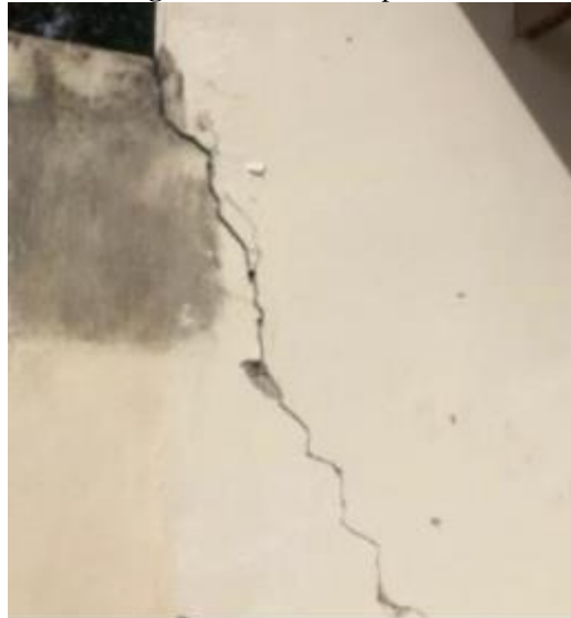
Figura 6 - Trinca em parede.
