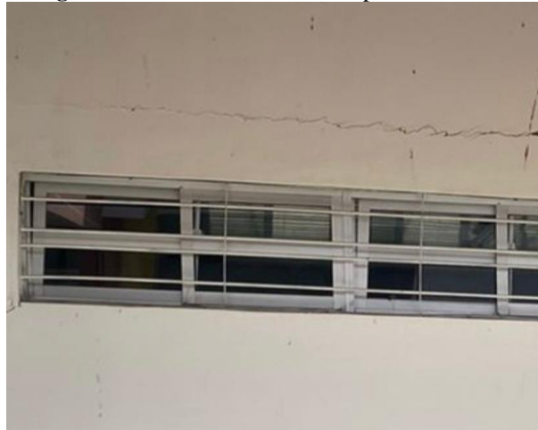
Figura 59 - Rachadura horizontal próximo ao teto.
