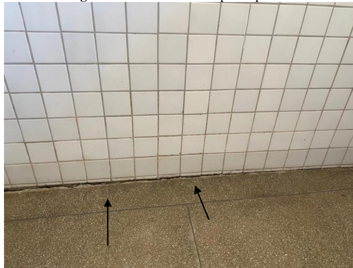
Figura 46 - Aberturas entre piso e parede.
