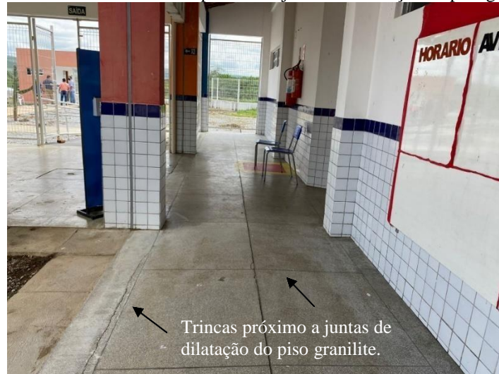
Figura 48 - Trincas observadas próximo a juntas de dilatação do piso granilite.
