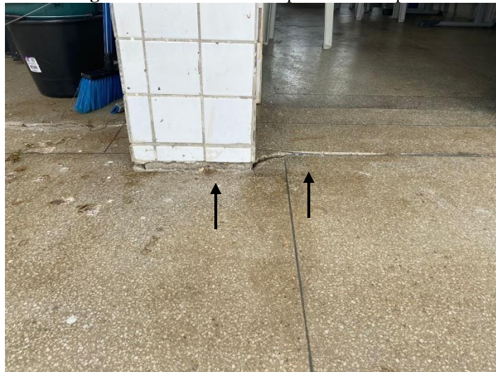
Figura 45 - Aberturas entre piso e solo no pilar.
