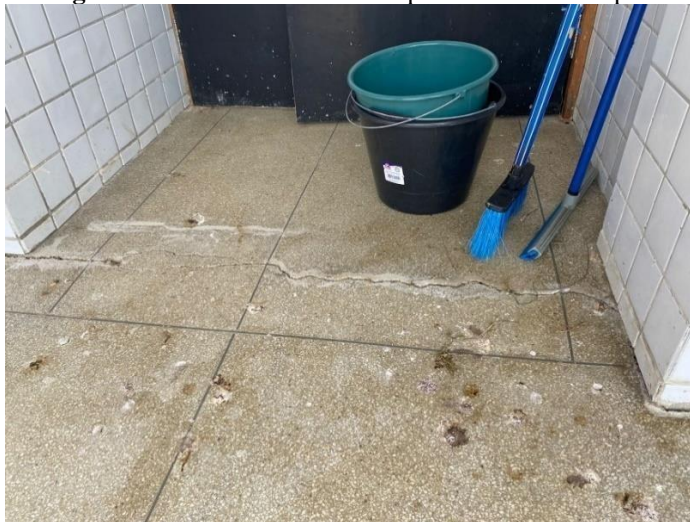
Figura 51 - Rachaduras com rompimento da resina epóxi.
