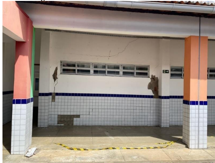
Figura 55 - Rachadura transversal na alvenaria.
