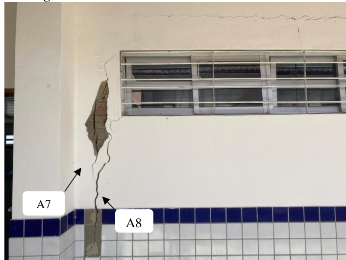
Figura 37 - Rachadura vertical sob os vãos de abertura.
