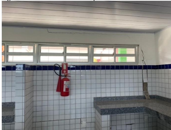
Figura 58 - Rachadura horizontal próximo ao teto no laboratório.
