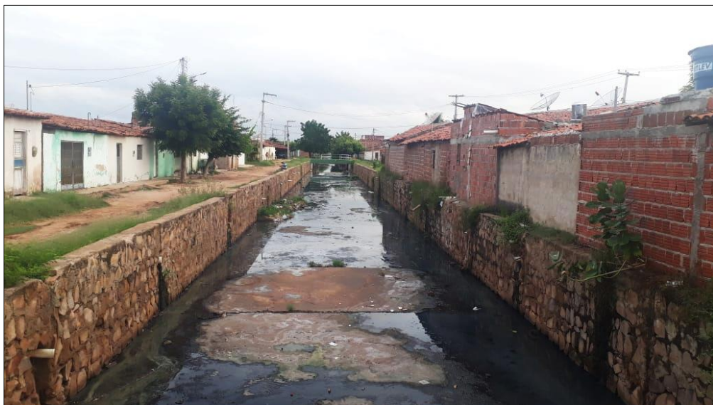
Figura 8 – Canal que recebe esgoto doméstico e que desemboca na lagoa de estabilização, localizada próxima ao bairro Angelim, Sousa, Paraíba.
