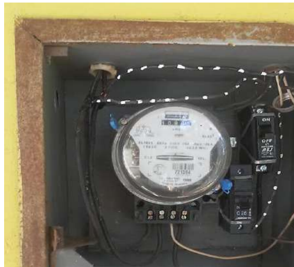
Figura 4 – Desvio de energia no ramal de entrada.
