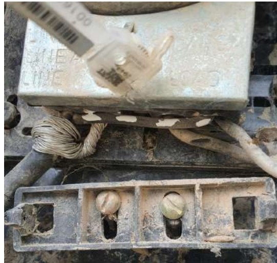
Figura 6 – Desvios nos bornes do medidor.
