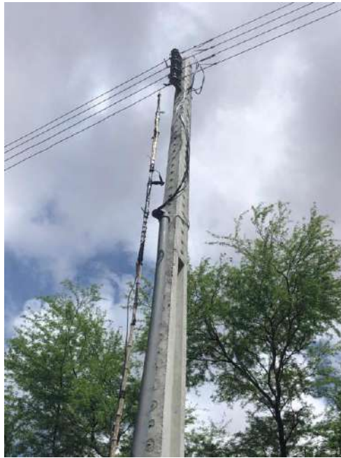
Figura 5 – Desvio de energia no ramal de ligação.
