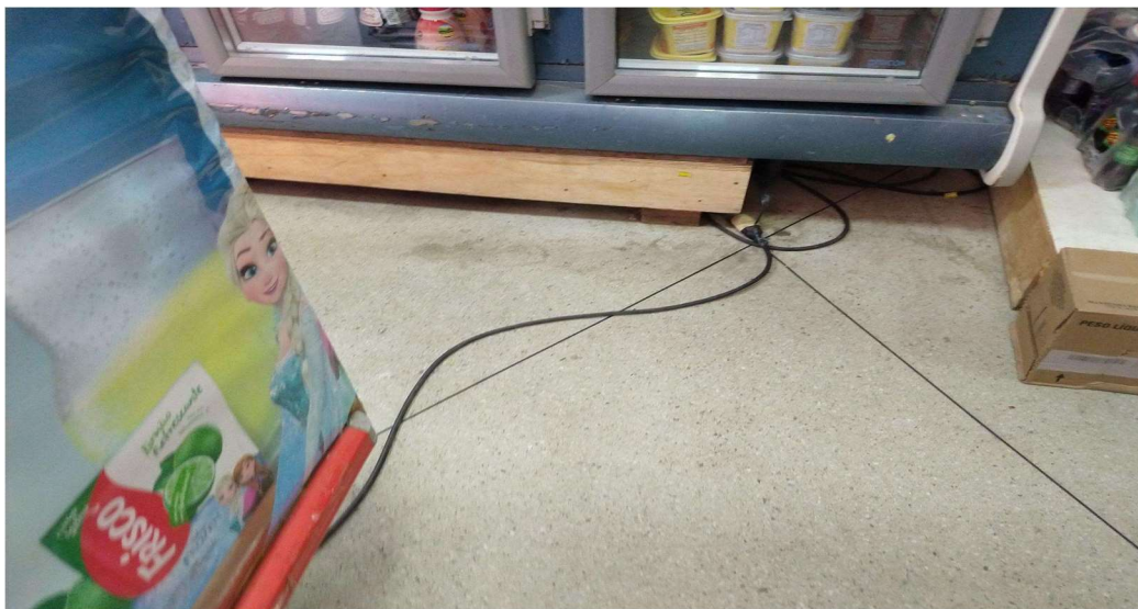
Figura 3 – Local dos produtos refrigerados e congelados com fiação exposta
