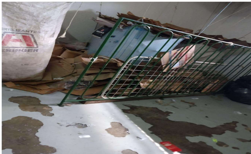
Figura 15 – Piso danificado no setor de armazenamento
