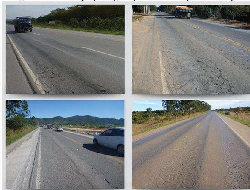
Figura 9 – Manifestação patológica tipo afundamento por consolidação.
