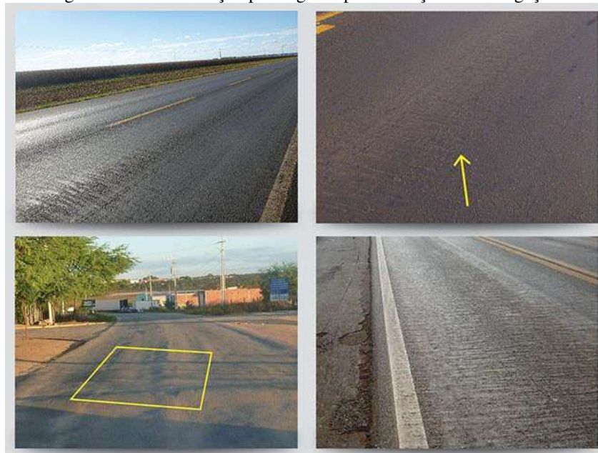
Figura 10 – Manifestação patológica tipo ondulação ou corrugação.
