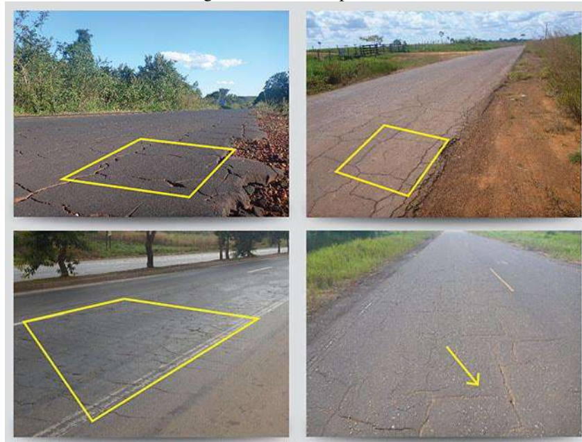
Figura 7 – Trincas tipo bloco.
