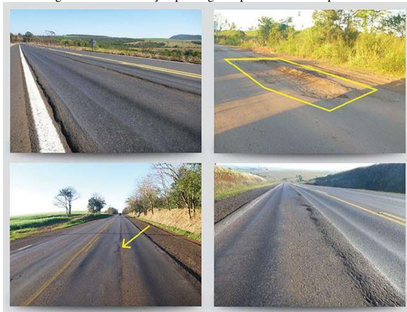
Figura 8 – Manifestação patológica tipo afundamento plástico.
