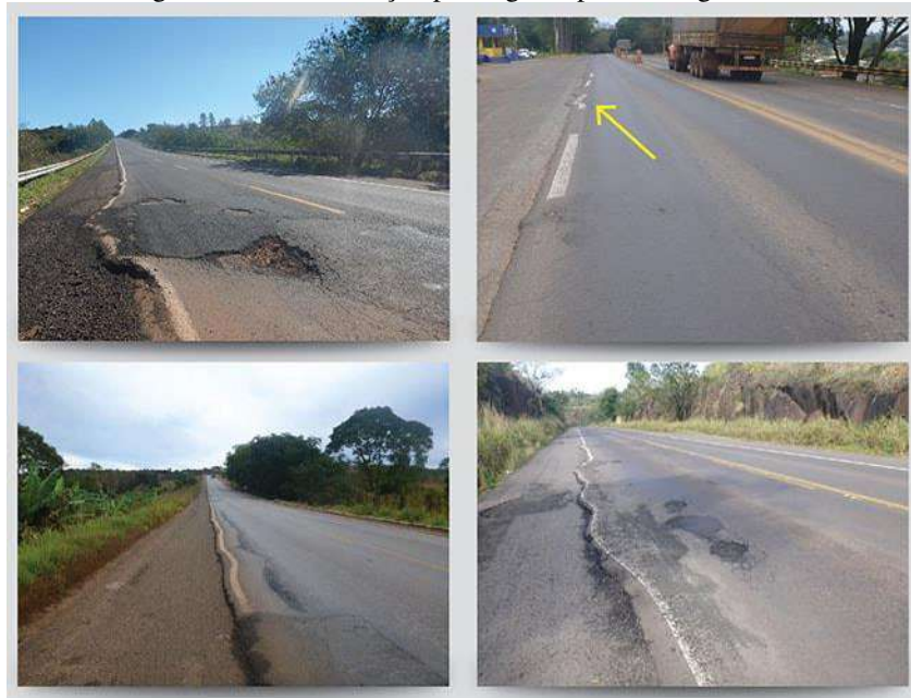
Figura 11 – Manifestação patológica tipo escorregamento.
