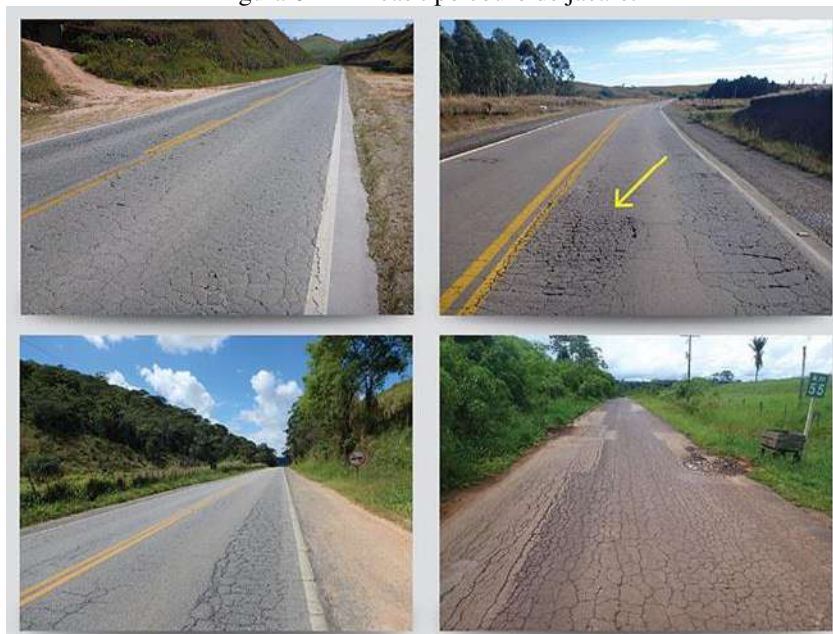
Figura 6 – Trincas tipo couro de jacaré.
