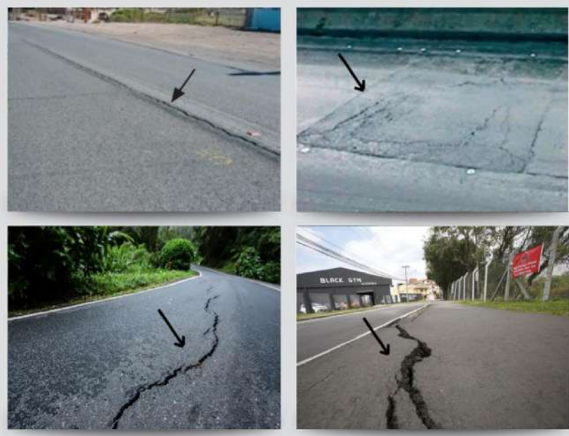
Figura 5 – Trincas por retração.
