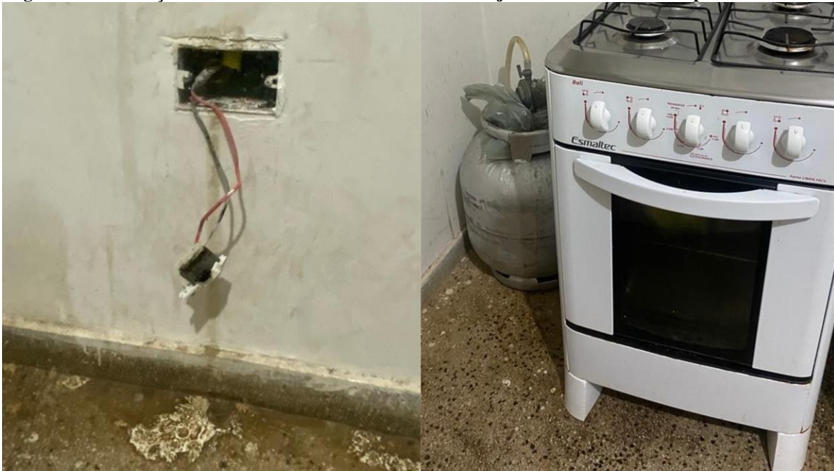
Figura 12 – Instalação Elétrica Mal Concebida Próximo a Botijão de Gás Butano na Copa da USF.
