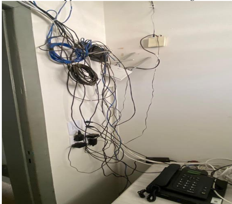
Figura 13 – Ambiente na Recepção com Excesso de Fios e Sobrecarga de Instalação Elétrica.
