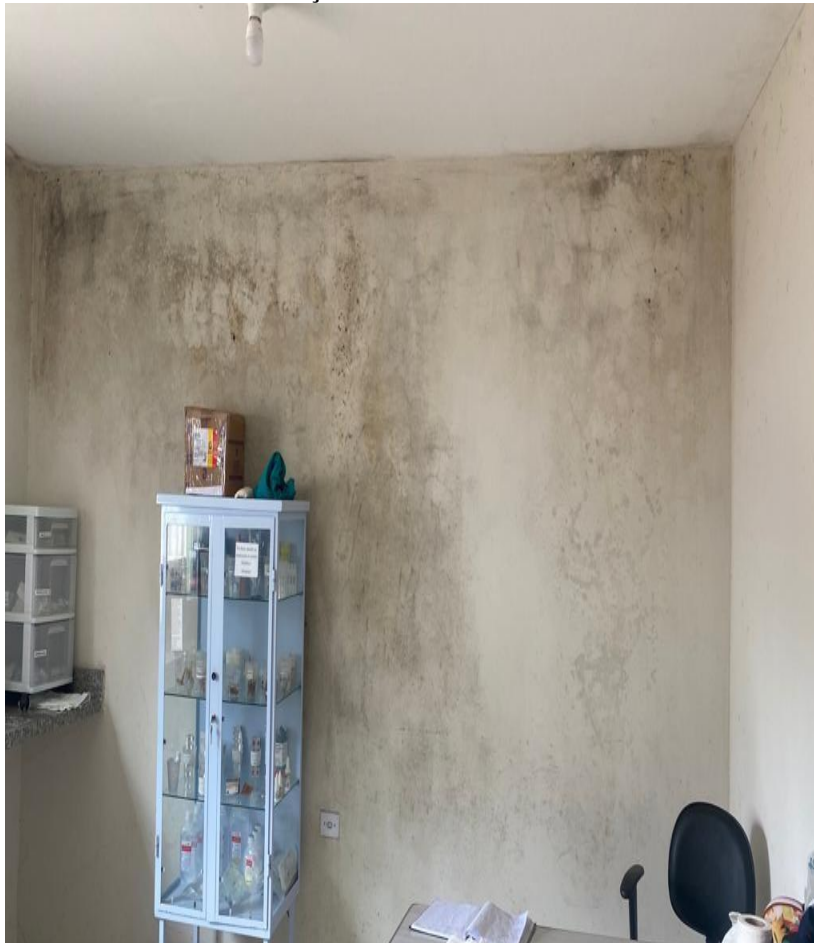
Figura 11 – Paredes com Presença de Umidade na Sala de Procedimentos da USF.
