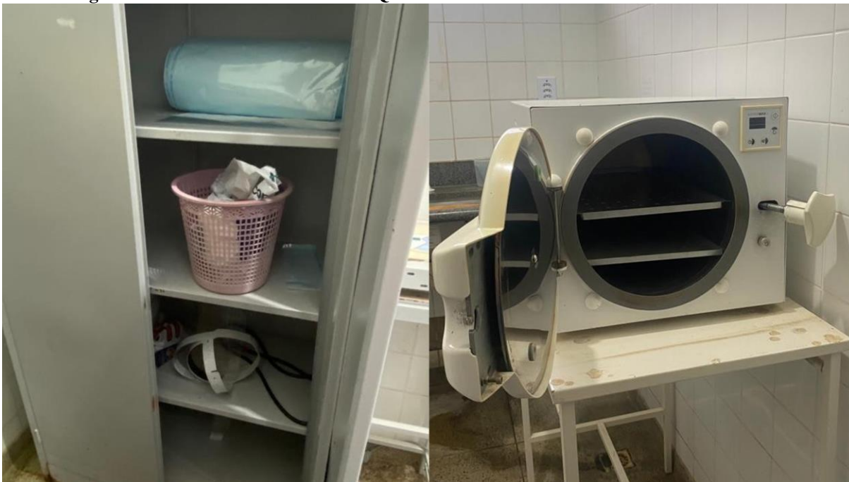
Figura 2 – Estrutura do Ambiente no Qual a Autoclave está Instalada na Unidade.
