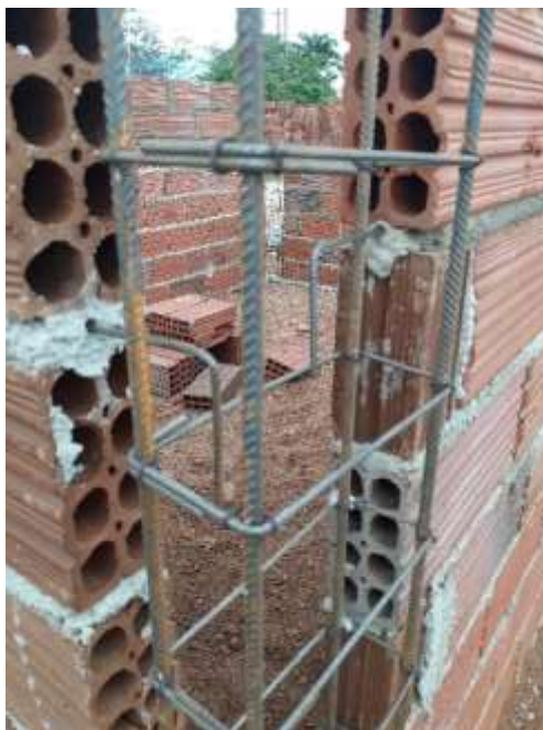
Figura 23 - Amarração entre alvenaria e pila.
