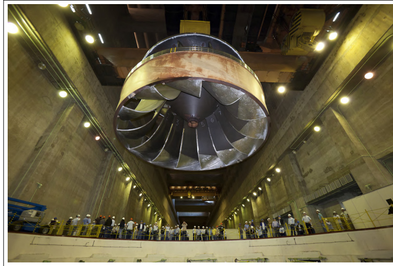
Figura 13 – Turbina da máquina geradora de Itaipu
