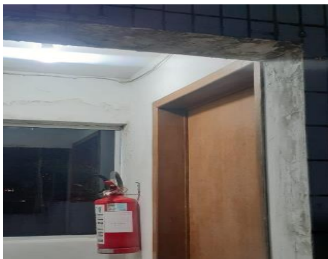
Figura 10 – Desagregação e mofo na pintura
