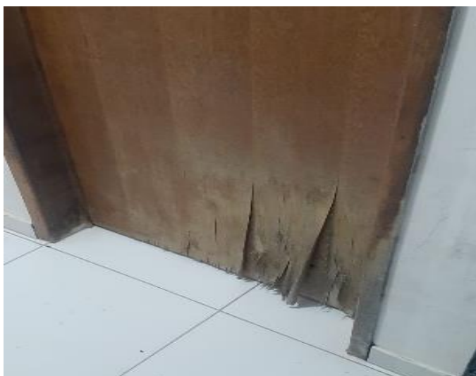
Figura 11 – Deterioração da porta da guarita
