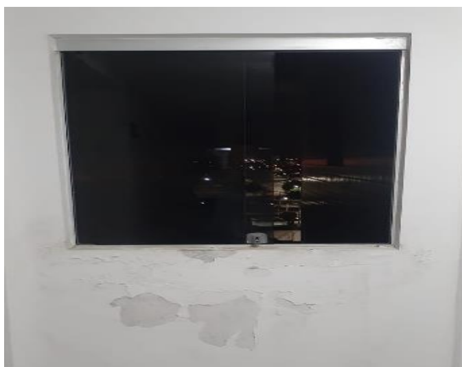
Figura 9 – Desagregação do revestimento na alvenaria
