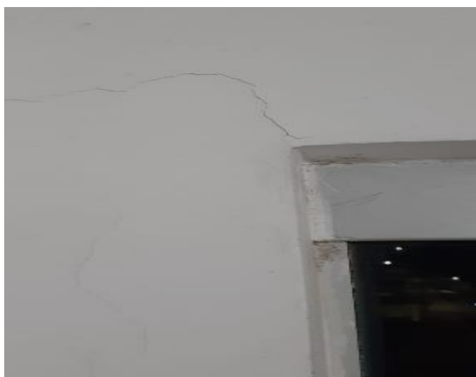
Figura 7 – Fissura no canto superior da janela
