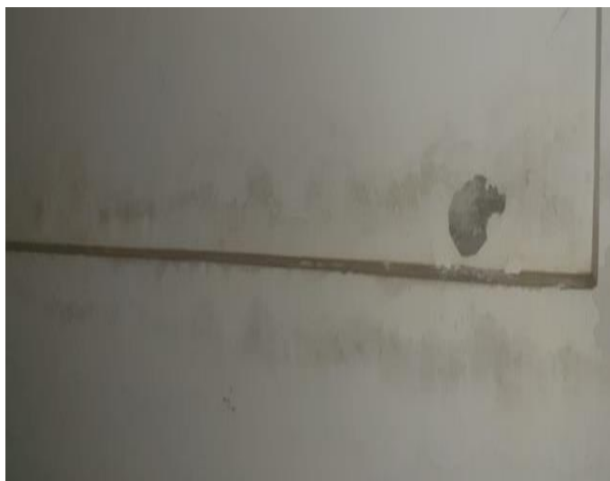
Figura 6 – Desagregação do revestimento na parede do 4º andar
