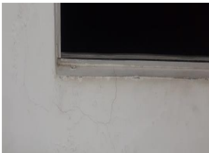
Figura 5 – Fissuras no canto inferior da janela
