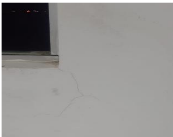
Figura 8 – Fissura no canto inferior da janela
