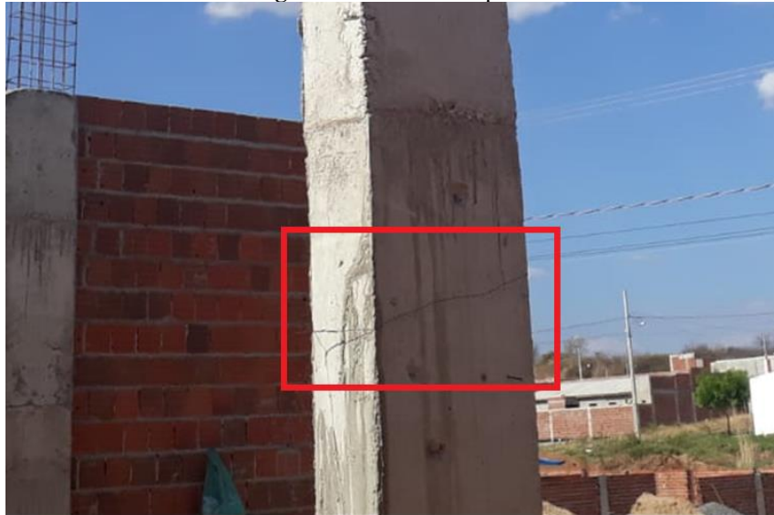
Figura 13 – Fissura no pilar.
