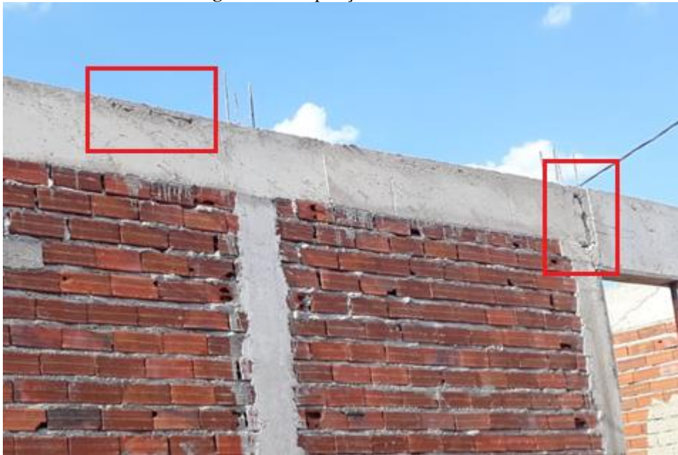
Figura 19 – Exposição das armaduras.
