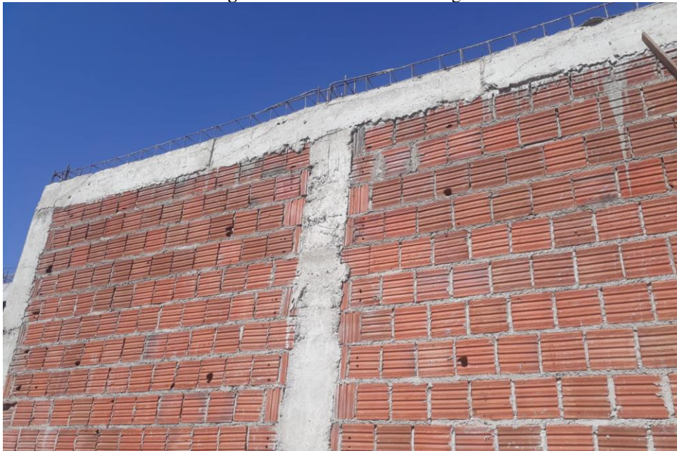
Figura 25 – Falha estética na viga.
