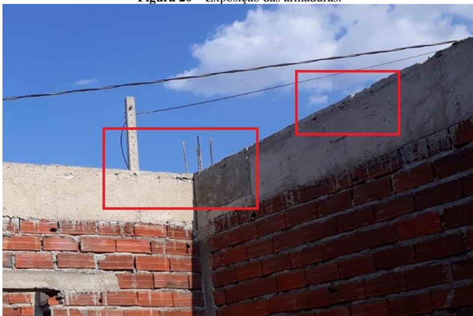
Figura 20 – Exposição das armaduras.
