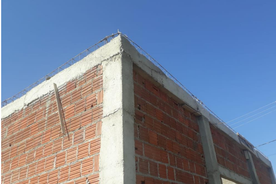
Figura 26 – Falha estética na viga.
