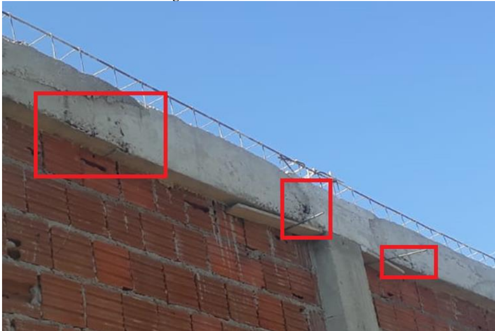
Figura 24 – Vazios no concreto.
