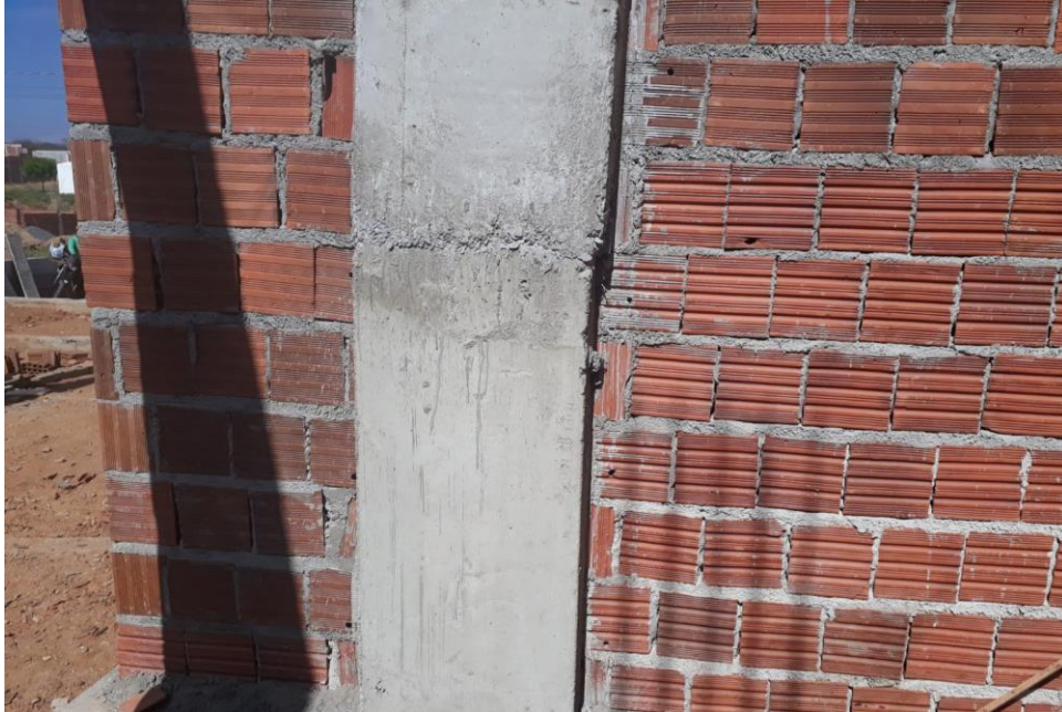
Figura 11 – Concreto segregado na coluna.
