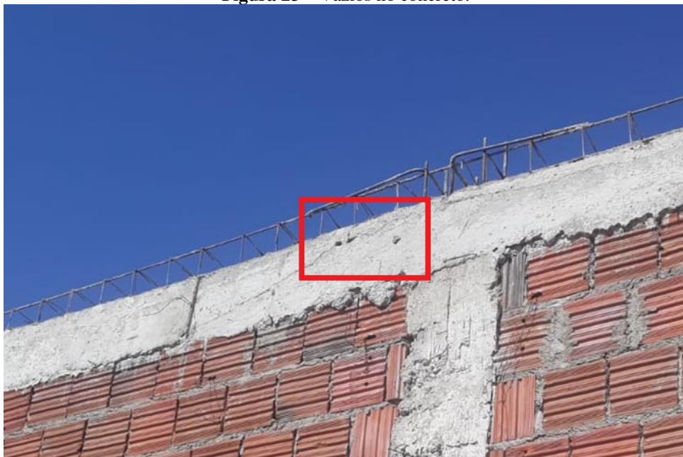
Figura 23 – Vazios no concreto.
