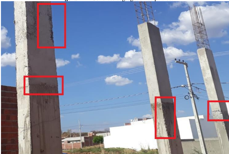
Figura 12 – Concreto segregado nos pilares.
