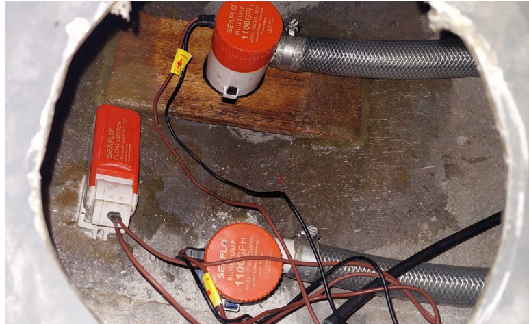
Figura 4 – Bomba de porão automática de uma embarcação tipo Stix.
