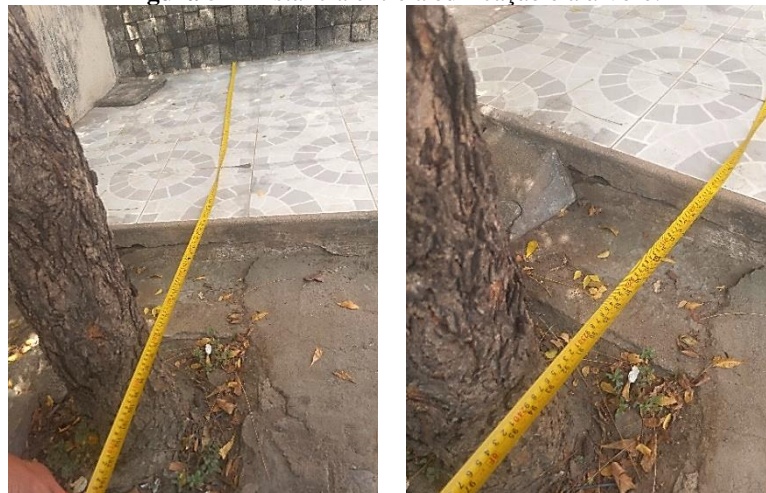
Figura 5 – Distância entre a edificação e a árvore.
