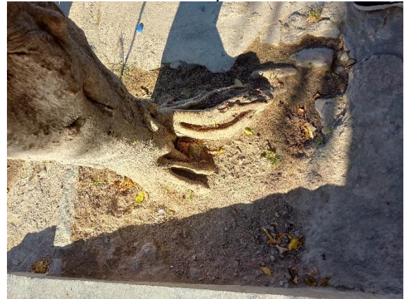
Figura 10 – Raízes expostas na calçada localizada na lateral esquerda.
