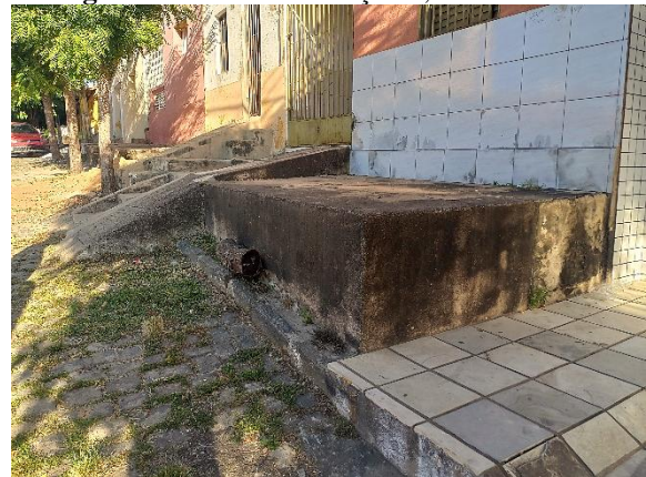
Figura 7 – Altura das calçadas, lateral direita.
