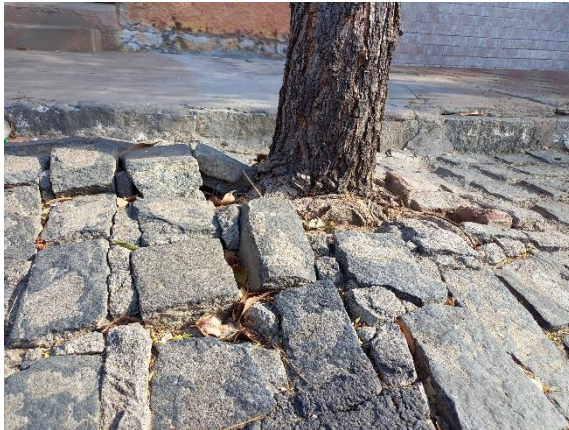
Figura 9 – Raízes levantando a pavimentação localizada na lateral direita.
