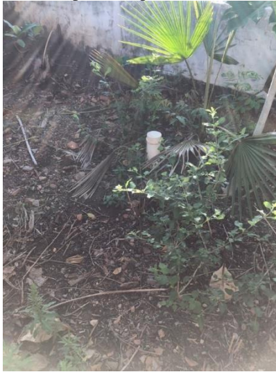
Figura 6 - Fossa séptica no quintal de um dos moradores.
