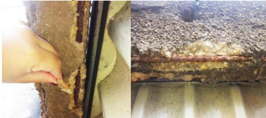
Figura 3 - Corrosão da armadura em viga.
