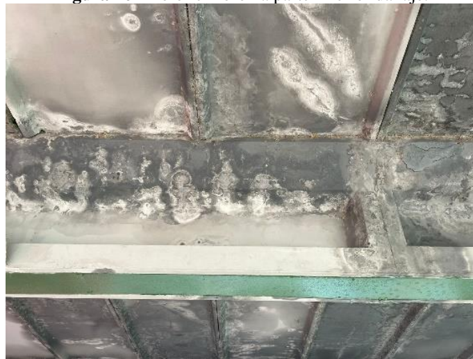
Figura 16 - Bolor e mofo na parte inferior da laje.
