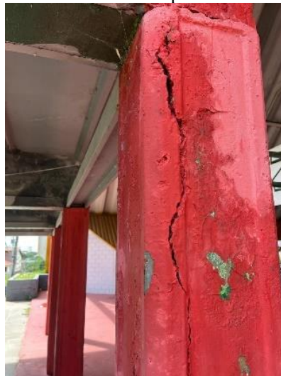
Figura 13 - Rachadura no pilar de sustentação.
