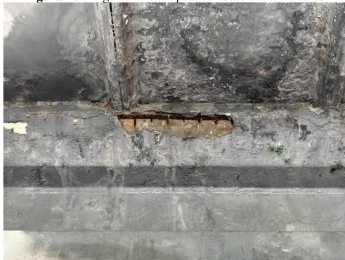
Figura 10 - Viga danificada pela corrosão das armaduras.
