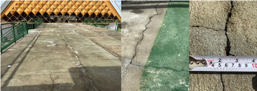
Figura 12 - Fissuras na parte superior da passarela.
