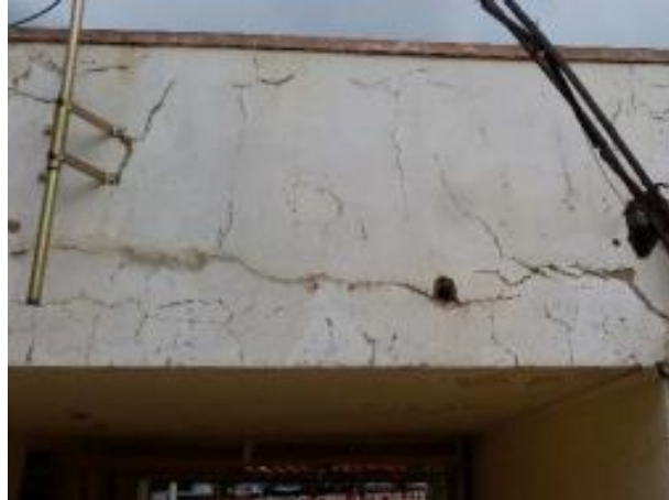
Figura 2 - Fissura externa em estrutura de concreto.
