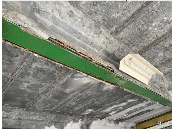
Figura 17 - Eflorescência causando danos na parte inferior da laje.
