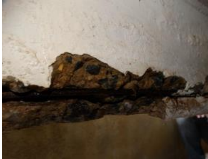
Figura 1 - Viga em processo de carbonatação.
