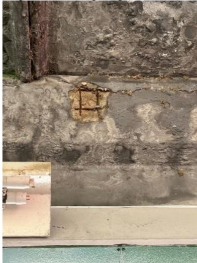
Figura 9 - Viga danificada pelo processo de carbonatação.
