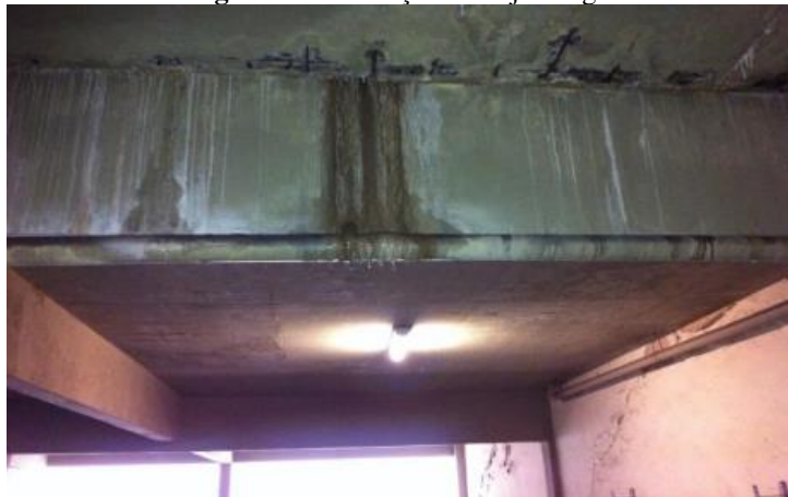
Figura 6 - Infiltração em laje e viga.
