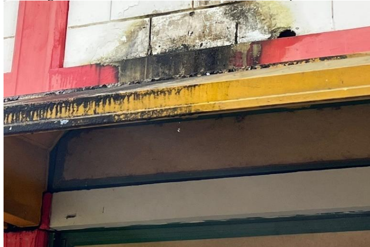
Figura 15 - Manchas de umidade na lateral da passarela.
