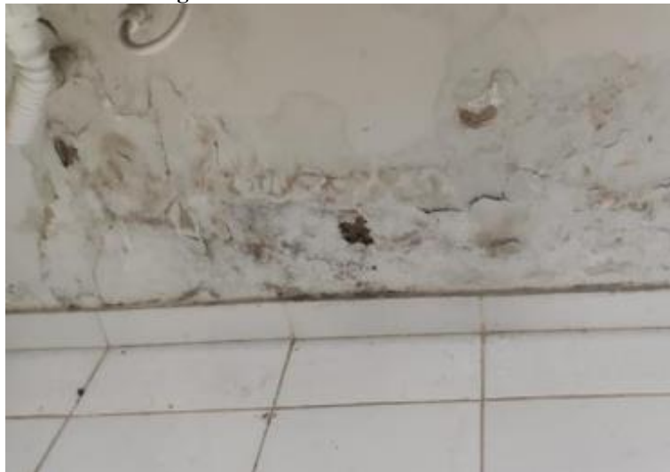
Figura 5 - Manchas devido a umidade.
