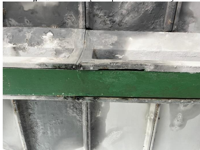
Figura 14 - Infiltração na parte inferior da laje.
