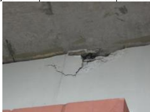
Figura 4 - Deslocamento do concreto por sobrecarga.
