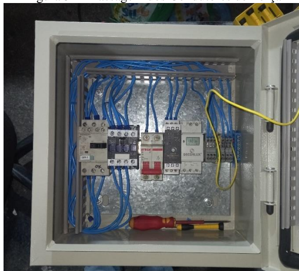
Figura 54 – Passagem dos Condutores de Força
