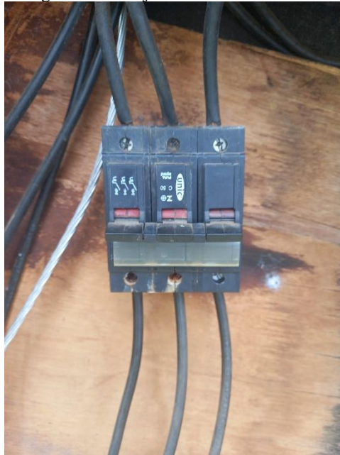
Figura 24 – Disjuntor Geral do Sistema
