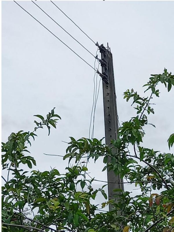
Figura 22 – Derivação de Rede Trifásica para o Fornecimento de Energia
