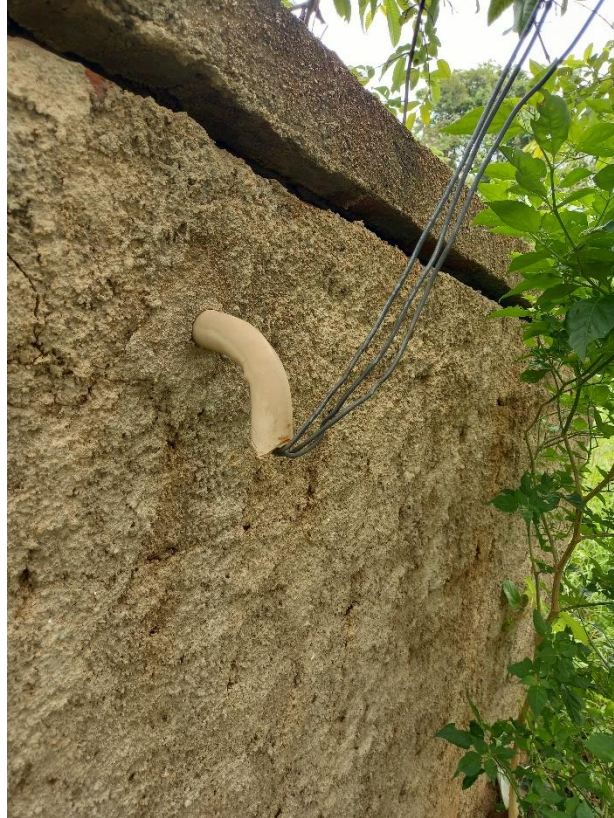
Figura 20 – Entrada da Rede Trifásica
