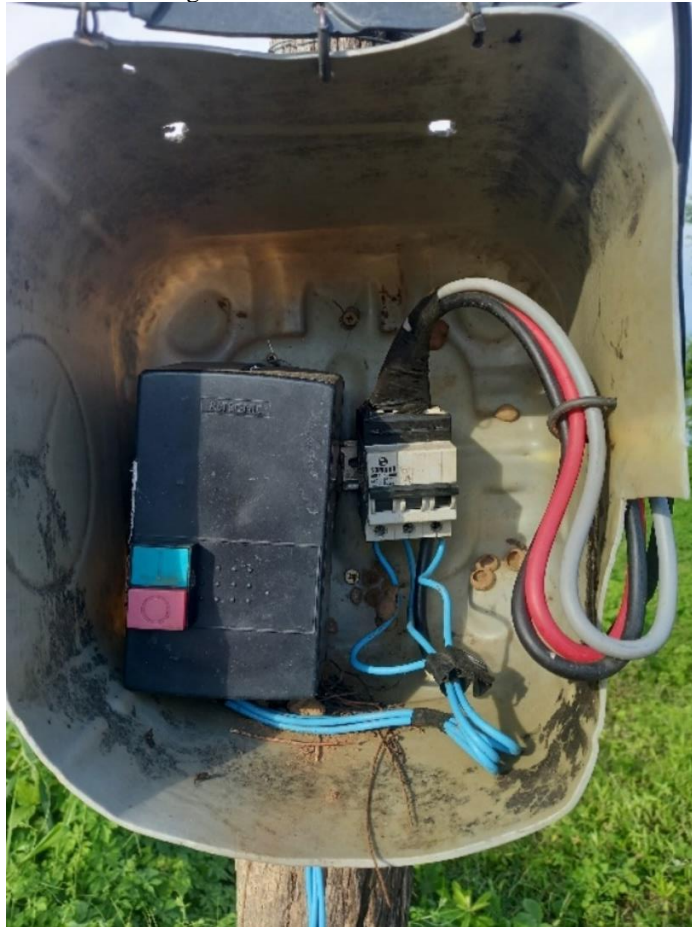
Figura 27 – Acionamento do Motor
