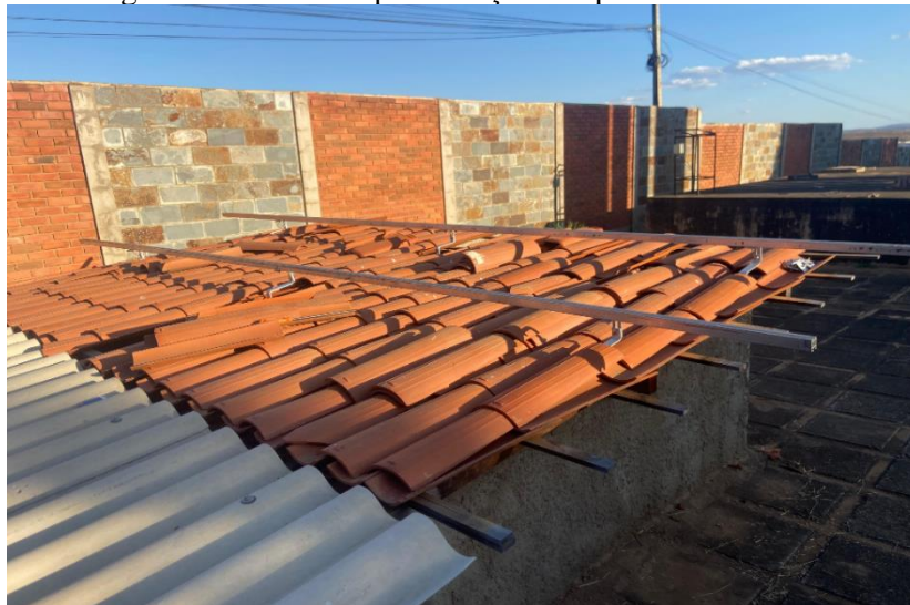
Figura 50 - Estrutura para fixação dos painéis instalados.
