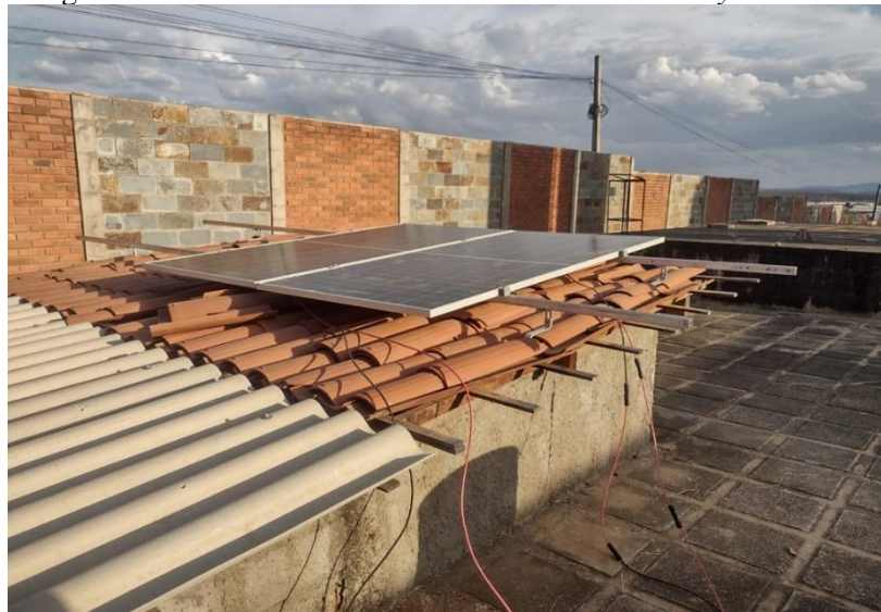
Figura 52 - Módulos conectados ao microinversor Deye de 2kW.
