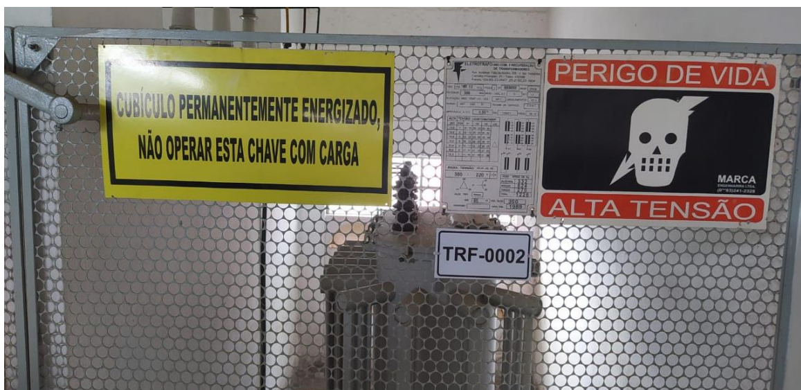
Figura 7. Transformador reserva de 300 kVA.
