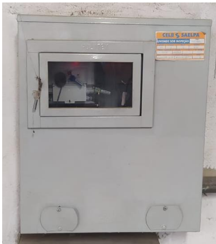
Figura 8. Medidor elétrico da indústria.
