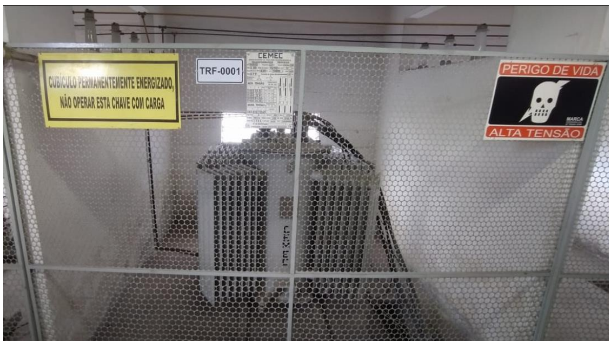
Figura 6. Transformador de tensão 500kVA.
