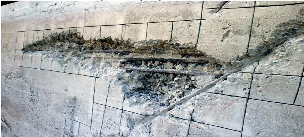
Figura 4 - Degradação do Concreto.
