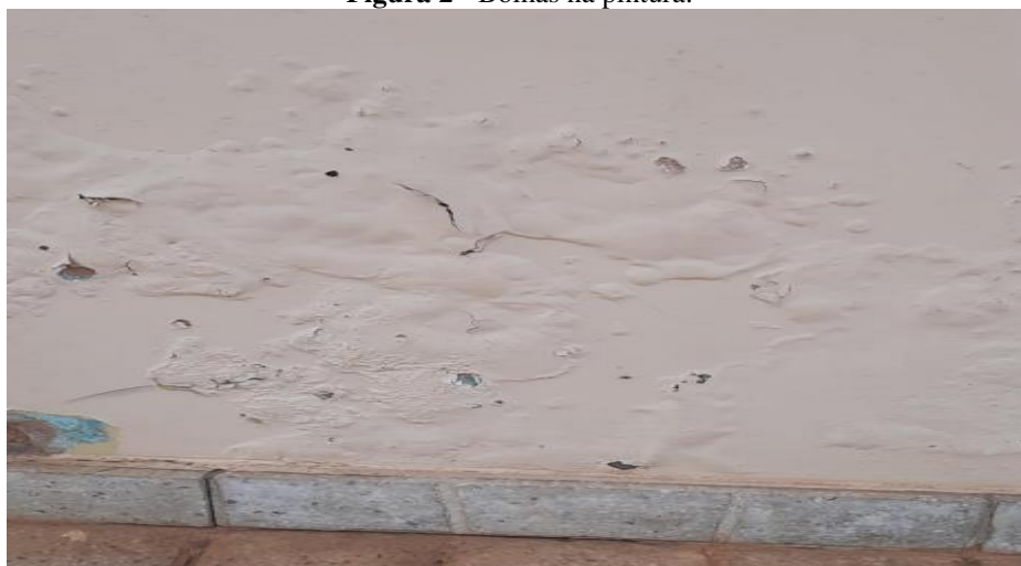
Figura 2 - Bolhas na pintura.
