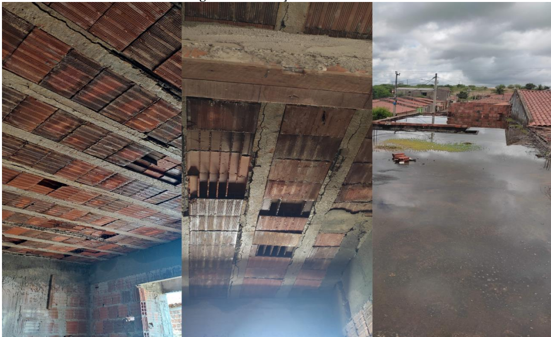
Figura 8 - Infiltrações e umidade.
