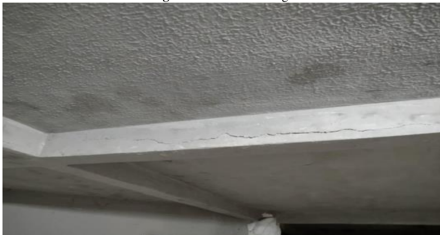
Figura 1 - Fissura em viga.
