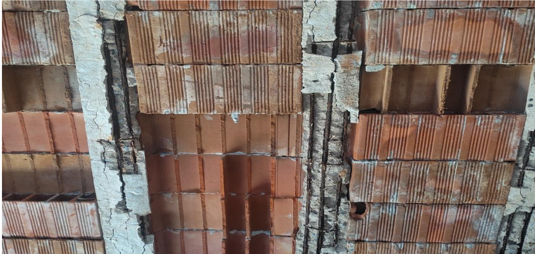
Figura 10 - Degradação do concreto.
