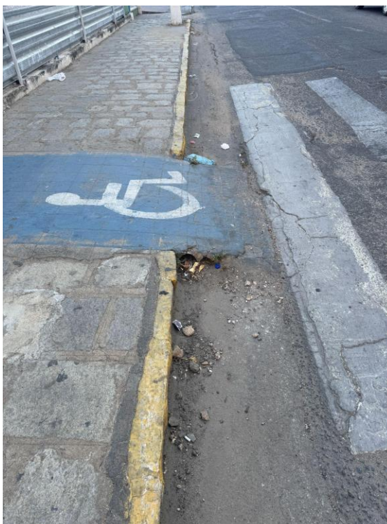
Figura 4 - Detalhe da obstrução da sarjeta por rampa de acessibilidade.
