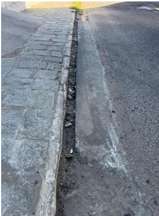
Figura 5 - Acúmulo de sedimentos e resíduos sólidos na sarjeta, reduzindo a seção hidráulica de escoamento.
