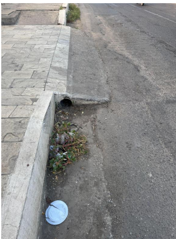
Figura 3 - Obstrução crítica do escoamento causada por rampa de acesso improvisada.
