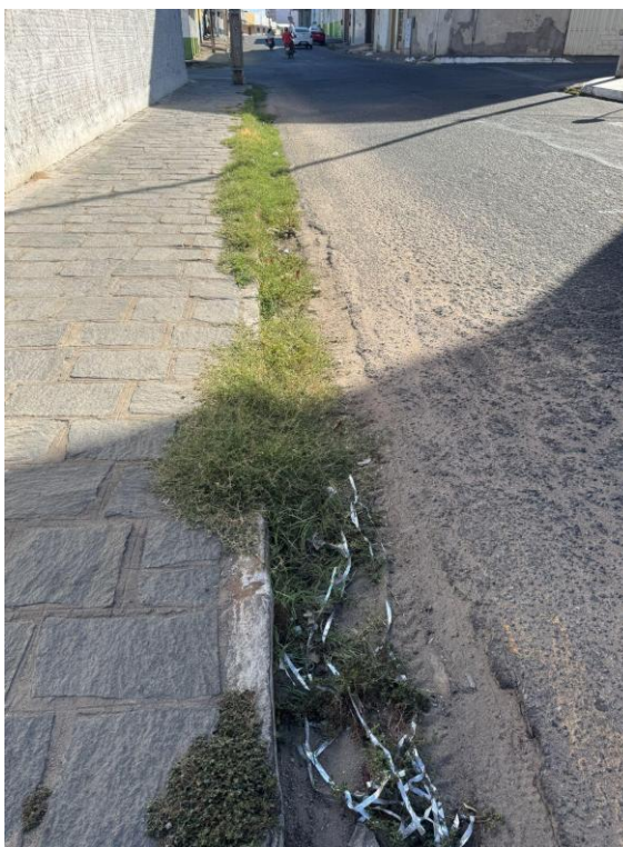
Figura 6 - Obstrução da sarjeta por crescimento de vegetação.
