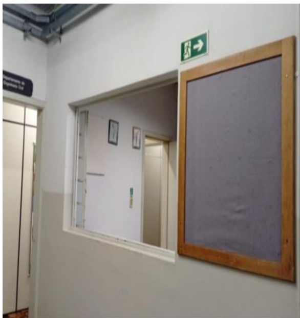
Figura 16 – Não conformidades na sinalização de emergência para rotas de fuga: instalação a 2,2m de altura.
