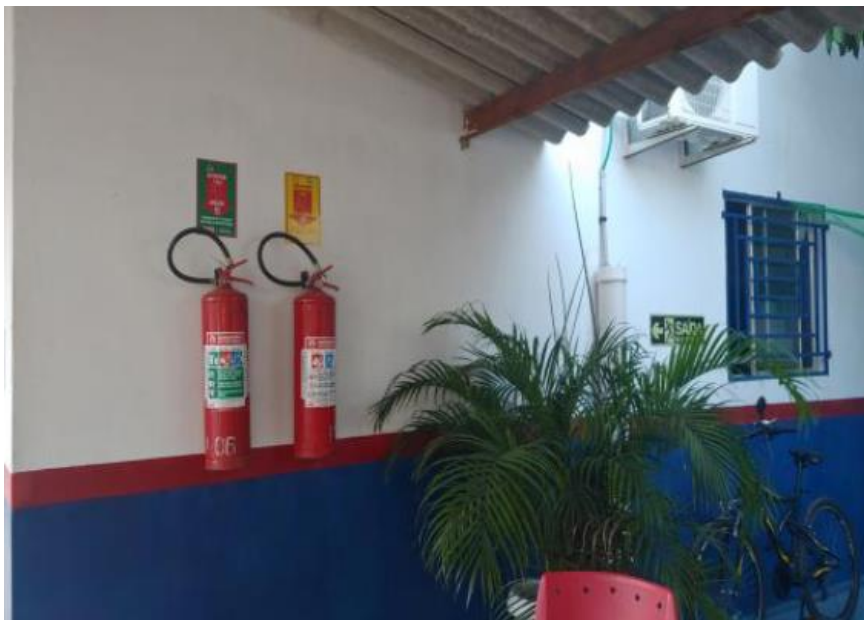
Figura 7 – Existência de extintores nas dependências de uma escola técnica no município de Alto do Rodrigues/RN.
