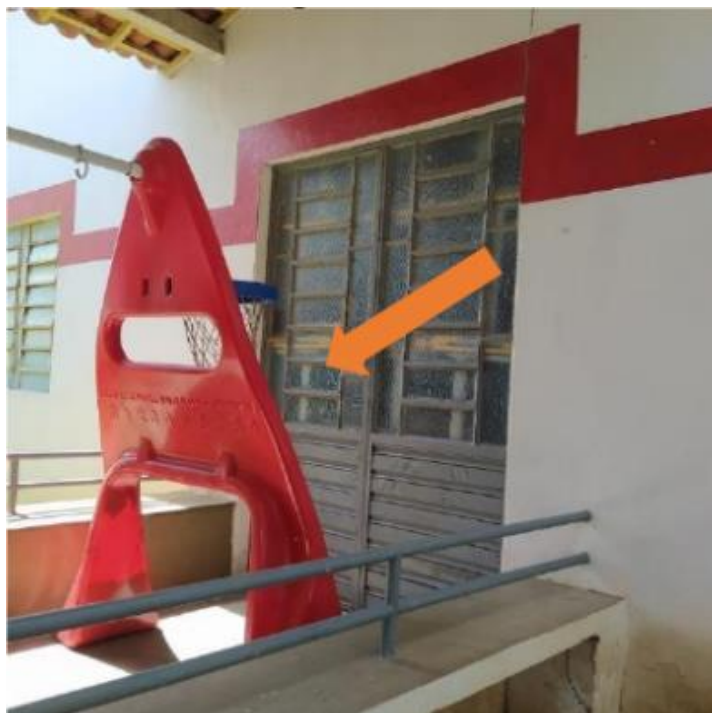
Figura 8 – Saída de emergência obstruída em uma escola pública no município de Cajazeiras-PB.
