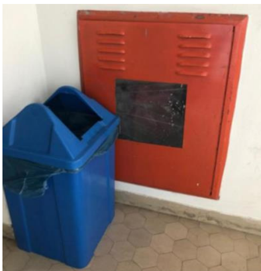
Figura 13 – Abrigo de hidrante vazio (sem acessórios).
