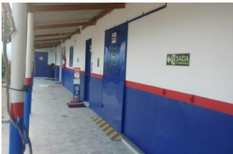
Figura 6 – Placas de sinalização de rotas de fuga existentes em uma escola técnica no município de Alto do Rodrigues/RN.
