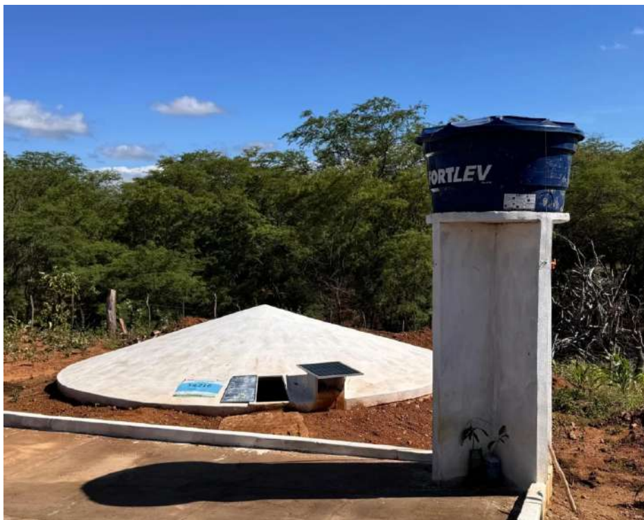
Figura 2.4: Exemplo de cisterna equipada com painel solar utilizado para alimentar sistemas IoT em regiões remotas [ASA Brasil 2025]
