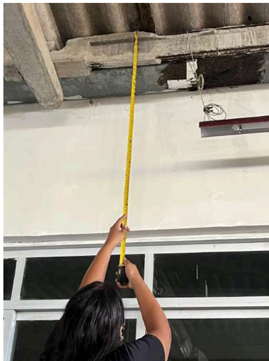
Figura 11 - Elemento estrutural estudado
