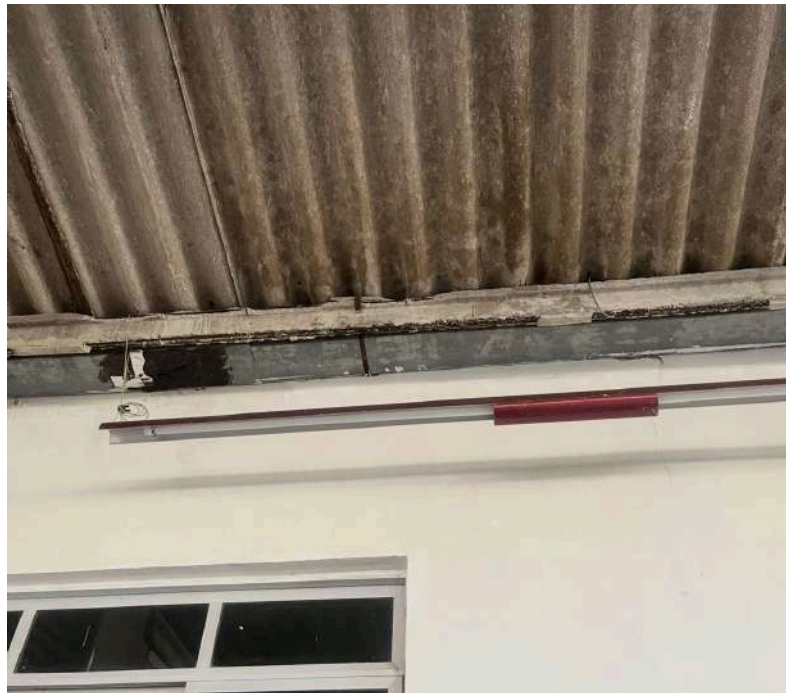
Figura 10 - Elemento estrutural estudado
