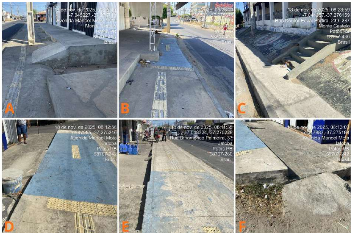
Figura 10 – Calçadas desniveladas nos trechos 3 e 4: (A, B e C) Trecho 3; (D, E e F) Trecho 4
