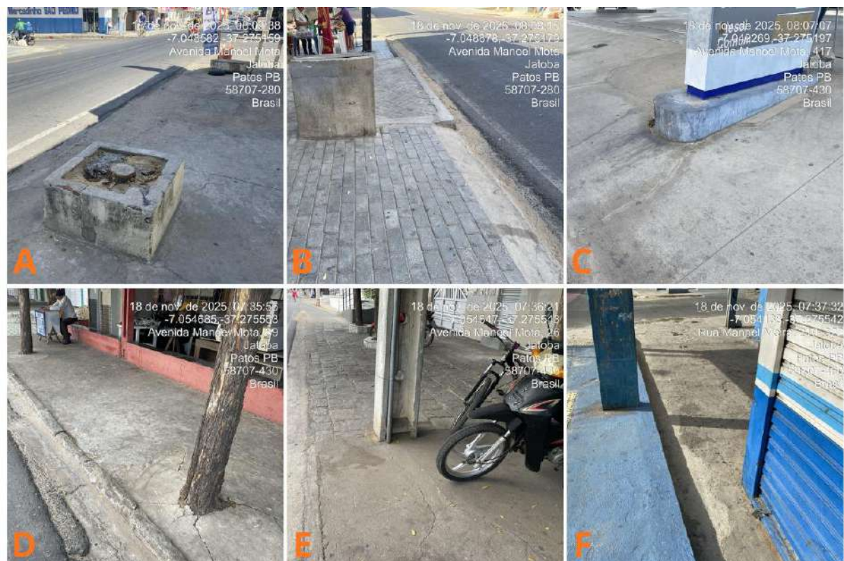
Figura 16– Obstrução nas calçadas dos trechos 5 e 7: (A, B e C) Trecho 5; (D, E e F) Trecho 7
