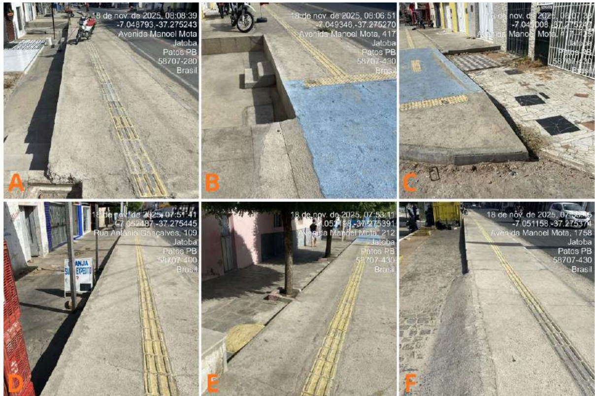
Figura 11 – Calçadas desniveladas nos trechos 5 e 6: (A, B e C) Trecho 5; (D, E e F) Trecho 6
