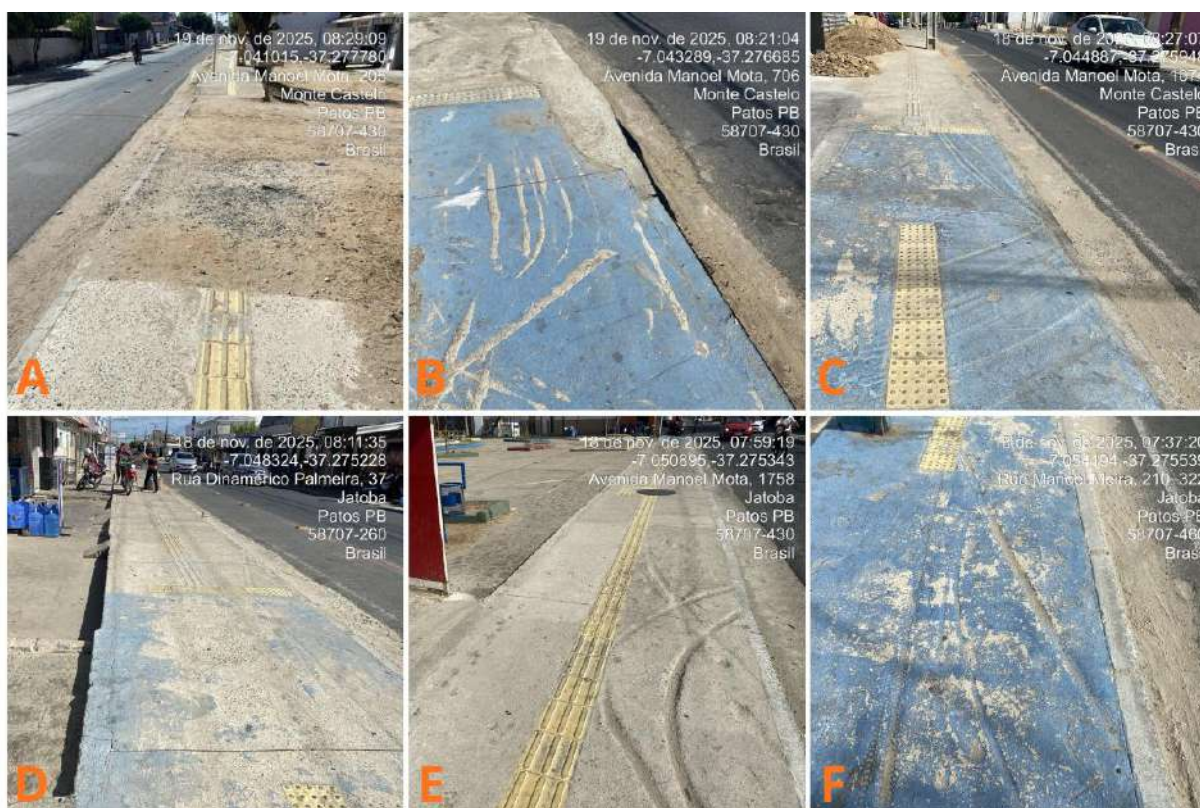
Figura 7 – Estado de conservação das calçadas: (A) Trecho 1; (B) Trecho 2; (C) Trecho 3; (D) Trecho 4; (E) Trecho 6; (F) Trecho 7
