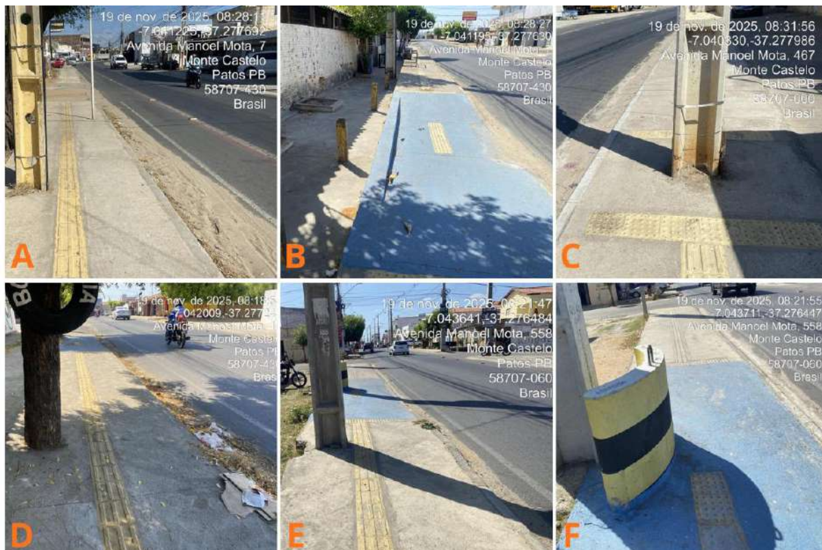
Figura 14— Obstrução nas calçadas dos trechos 1 e 2: (A, B e C) Trecho 1; (D, E e F) Trecho 2
