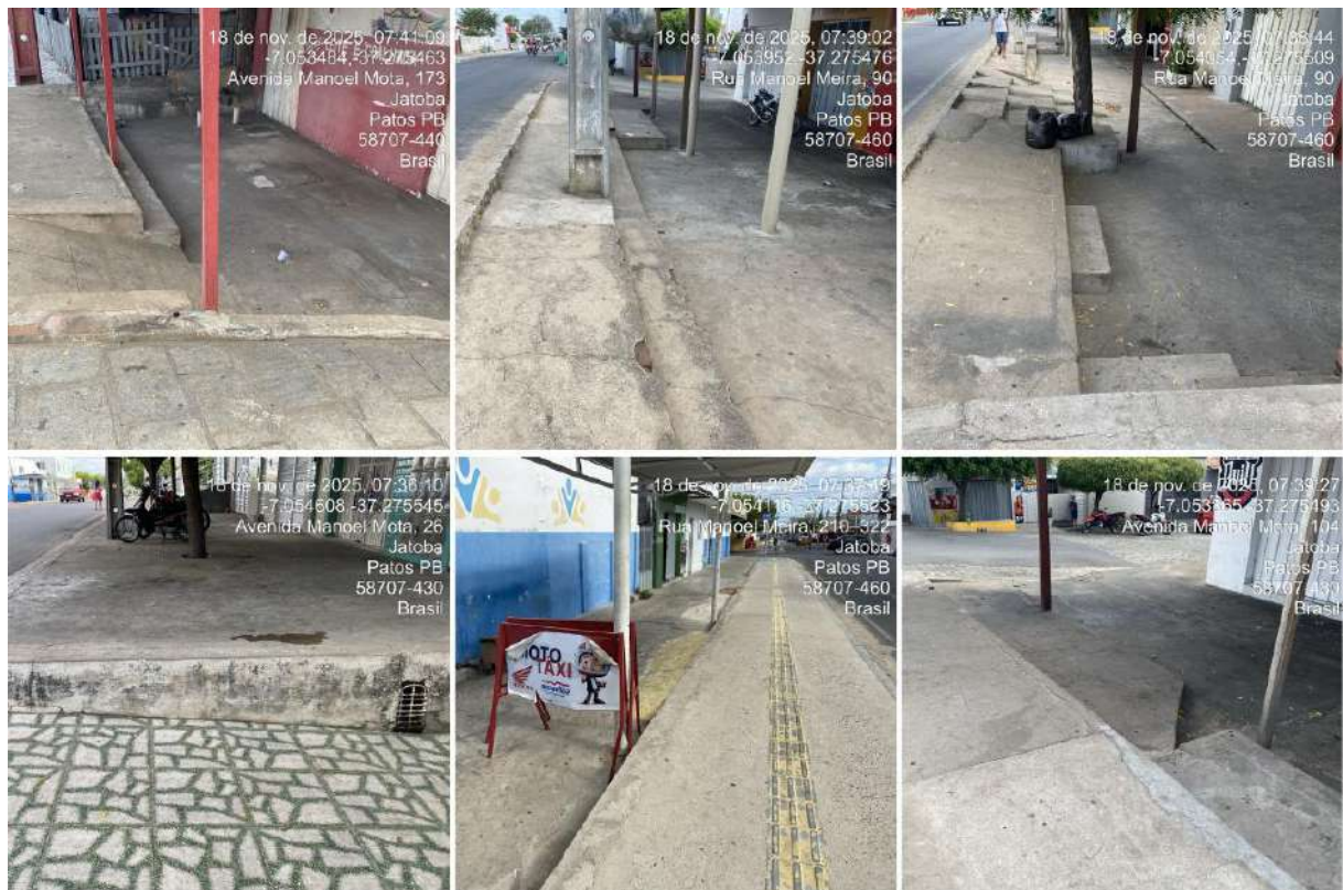
Figura 12 – Calçadas desniveladas no trecho 7
