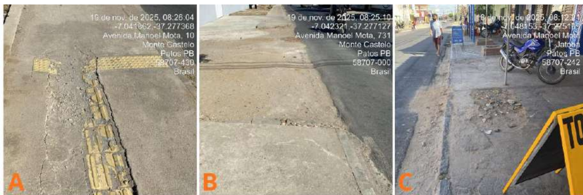
Figura 8 – Calçadas quebradas: (A) Trecho 2; (B) Trecho 3; (C) Trecho 4
