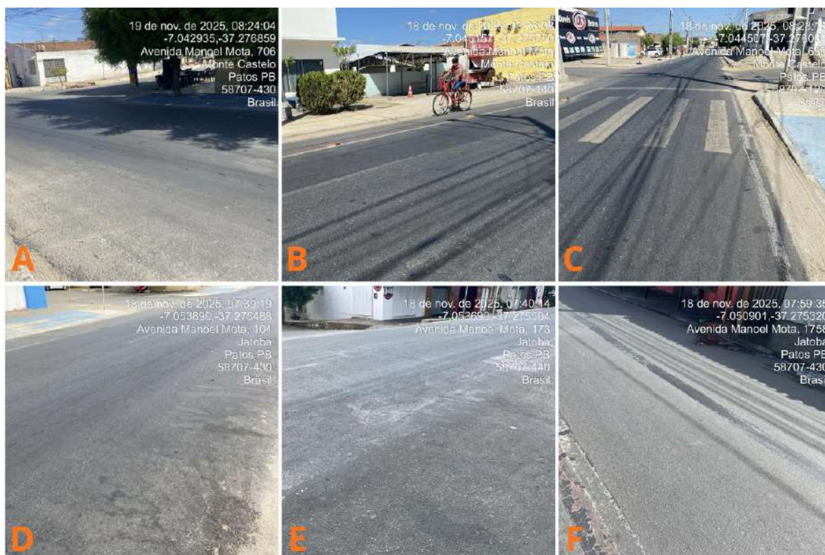
Figura 21 – Estado de conservação e sinalização horizontal da faixa de rolamento: (A) Trecho 2; (B) Trecho 3; (C) Trecho 4; (D) Trecho 5; (E) Trecho 6; (F) Trecho 7
