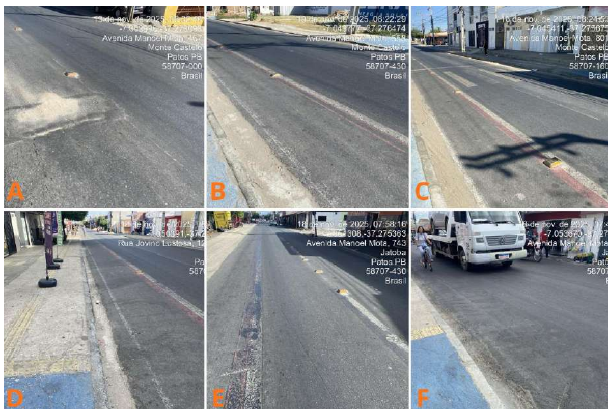
Figura 20 – Estado de Conservação da Ciclofaixa: (A) Trecho 1; (B) Trecho 2; (C) Trecho 3; (D) Trecho 4; (E) Trecho 5; (F) Trecho 6
