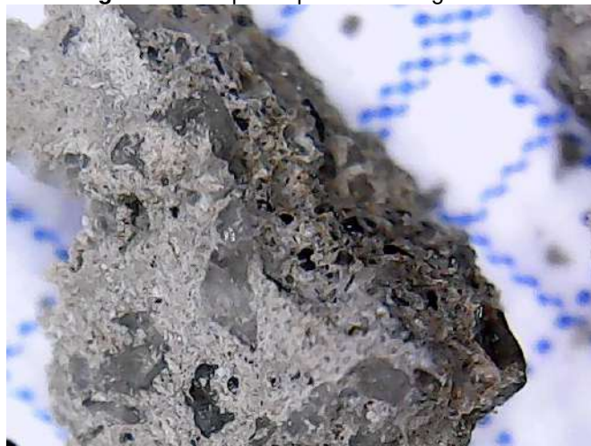
Figura 39 - Aspecto poroso da argamassa
