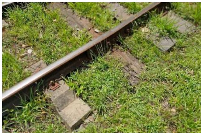
Figura 3 - Dormentes variados (concreto, madeira e plástico) em uma mesma linha
