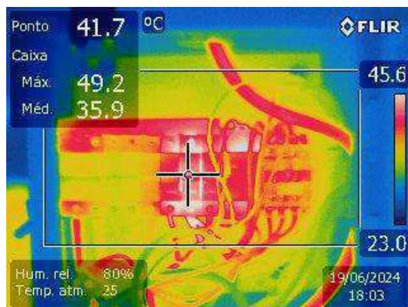
Figuras 57: Quadro de automação com temperaturas que necessitam de acompanhamento.
