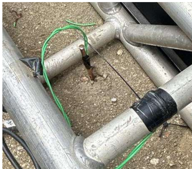
Figura 26: Conexão irregular de aterramento.
