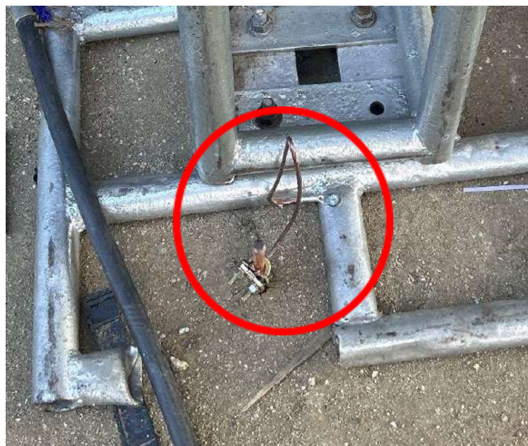
Figura 8: Conexão de Aterramento do Palco.
