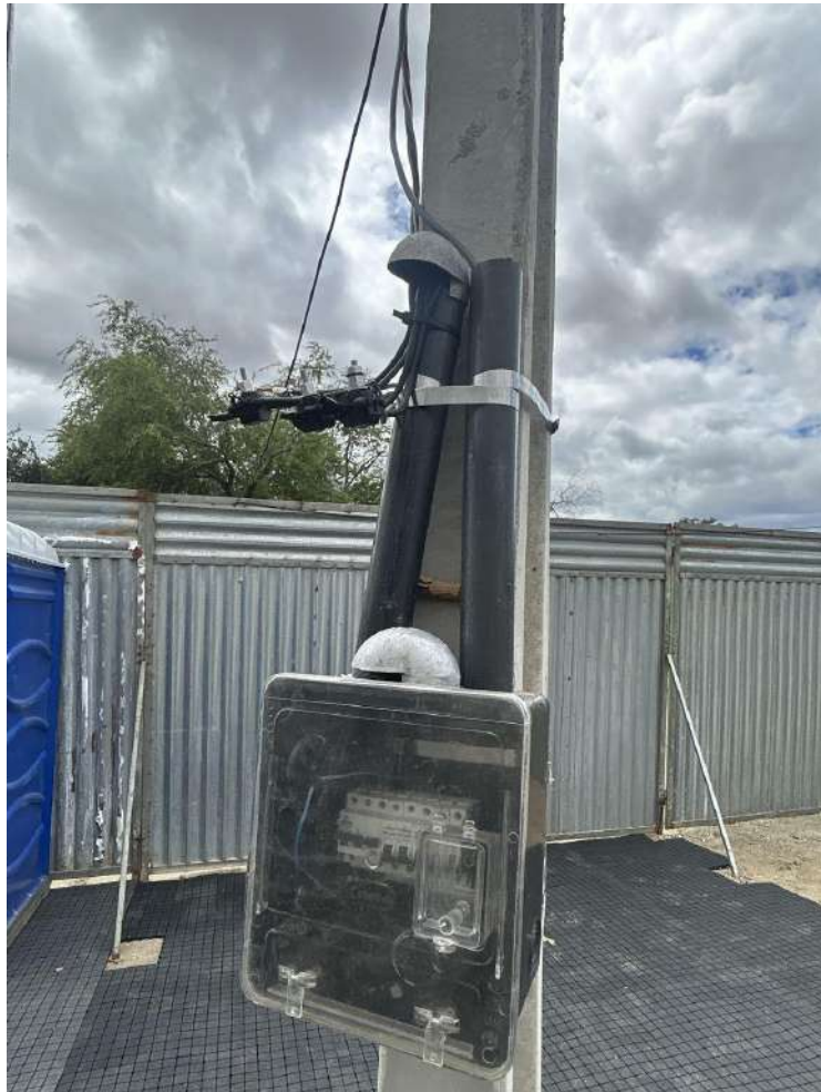
Figura 4: Instalações da rede de baixa tensão com quadro de distribuição para o sistema de iluminação.
