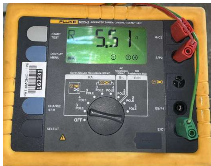
Figura 25: Nova medição de aterramento da estrutura.
