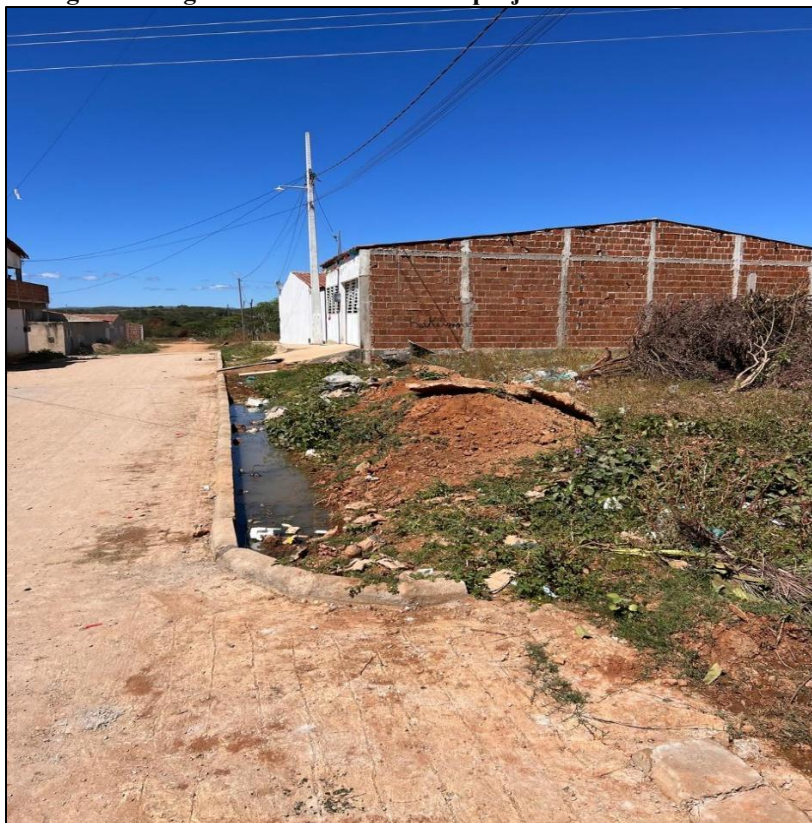
Figura 6: Esgoto a céu aberto em rua projetada de Diamante-PB.
