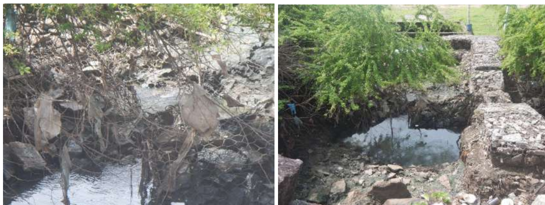
Figura 8: Canal de dragagem com presença de resíduos sólidos
