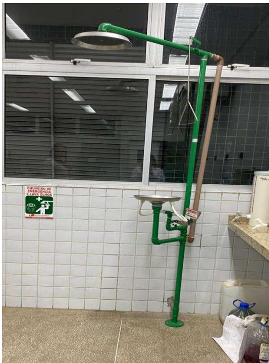
Figura 09: Equipamentos de proteção coletiva: Chuveiro com lava-olhos
