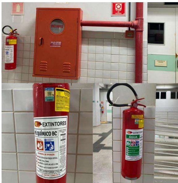
Figura 07: Extintores disponíveis próximos aos laboratórios
