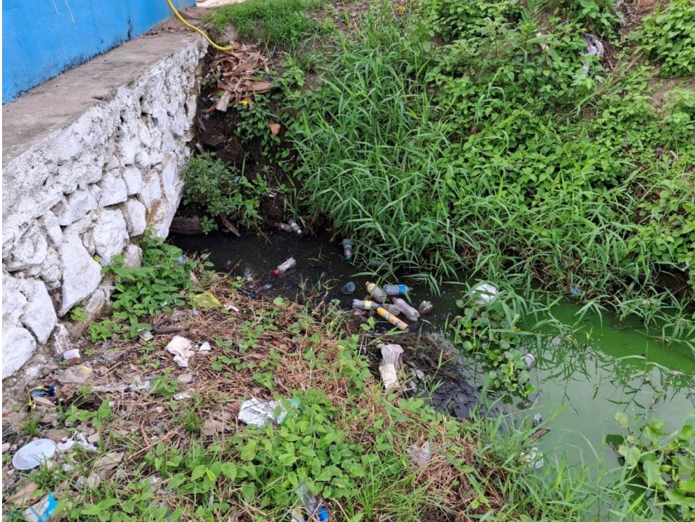
Figura 8 – Ponto de efluente de esgoto e descarte de resíduos sólidos identificado por trás do comércio E3.
