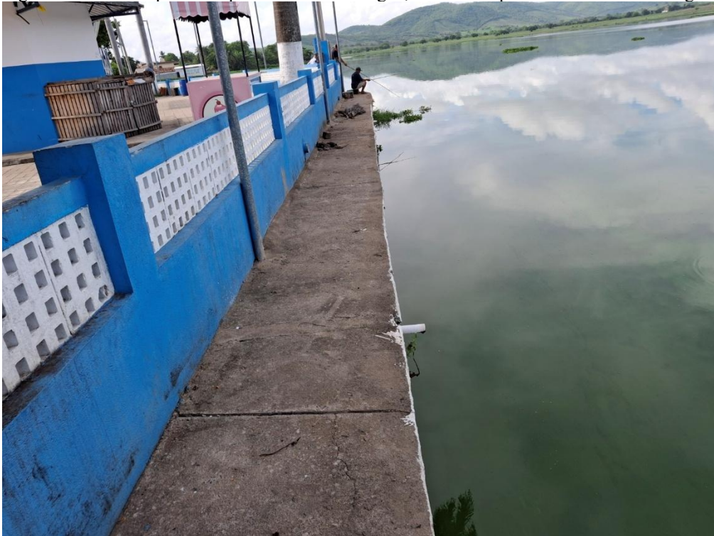
Figura 13 – Canos apontados para o interior da lagoa, mostrando possíveis efluentes de esgoto.
