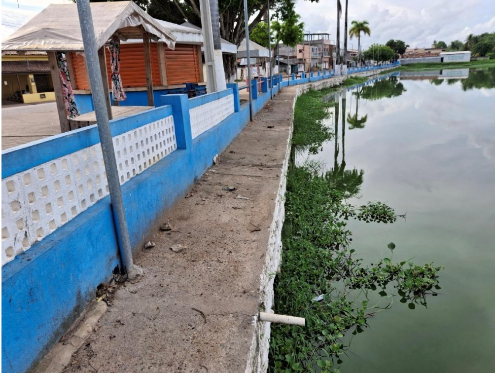
Figura 12 – Canos apontados para o interior da lagoa, mostrando possíveis efluentes de esgoto.
