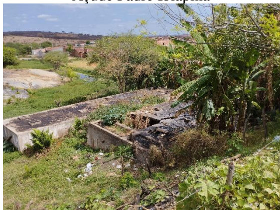
Figura -7- Estação de Tratamento de Esgoto inutilizada no barramento do Açude Padre Ibiapina
