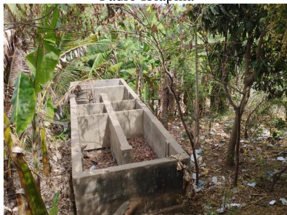
Figura 08 - Estação de Tratamento de Esgoto inutilizada no barramento do Açude Padre Ibiapina
